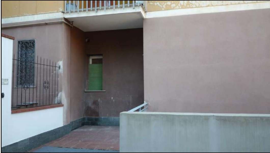
Porzione di facciata ovest con vista finestra murata internamente e foro di aerazione wc- Fotografia 5
