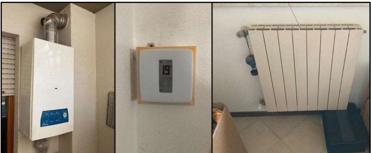
Impianto riscaldamento: caldaia murale, termostato, radiatore
