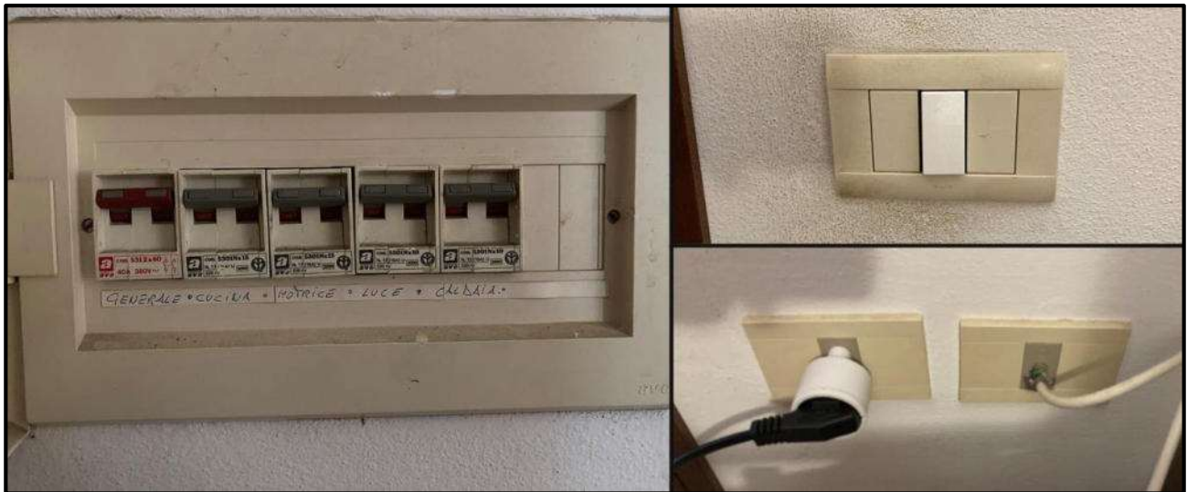
Impianto elettrico: quadretto in appartamento e dettagli dell'impianto
