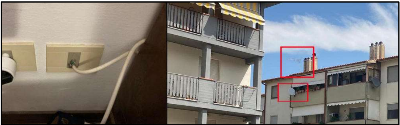
Impianto radiotelevisivo: antenna condominiale, parabola, prese tv nell'unità residenziale
