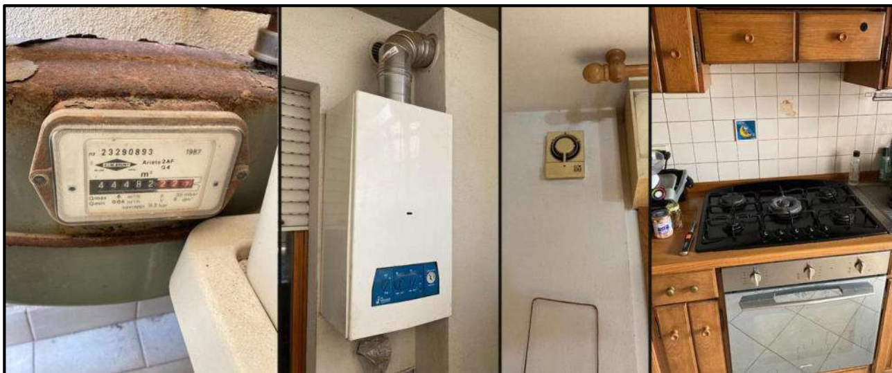
Impianto gas: contatore di fornitura, caldaia, areazione cucina, piano cottura con cappa
