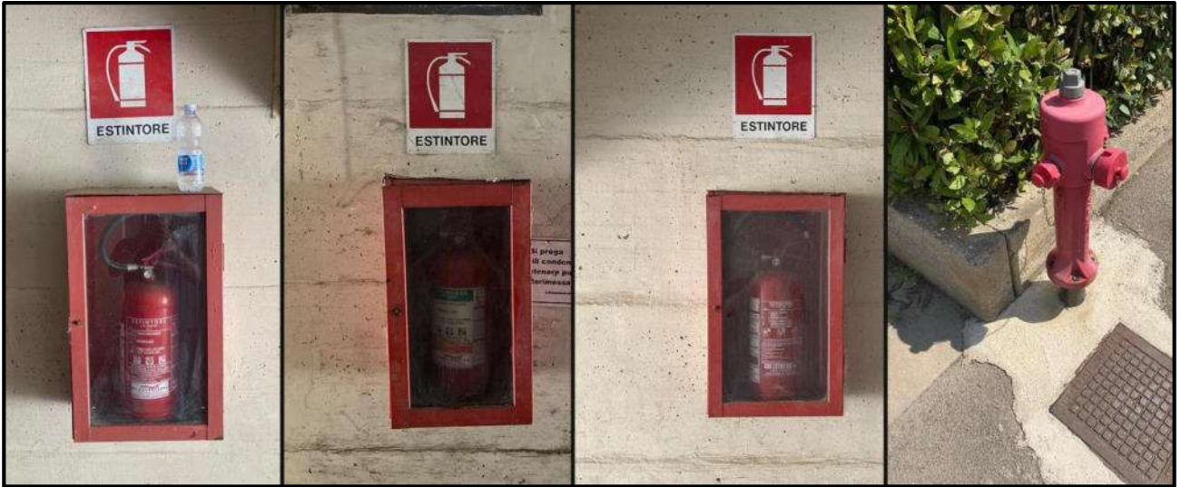
Impianto antincendio autorimessa condominiale: 3 estintori ed attacco per vigili del fuoco su strada
