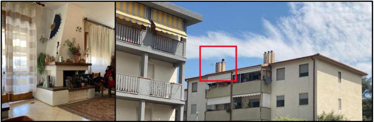
Impianto riscaldamento: camino e espulsione fumi
