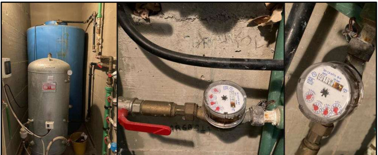
Impianto idrico: contatore di fornitura idrica
