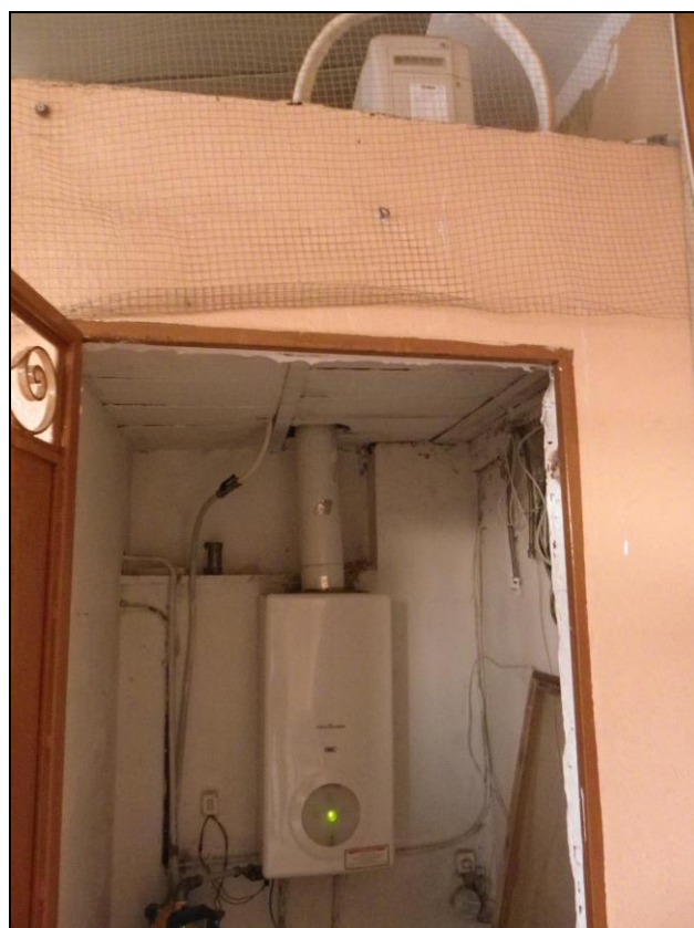
Fig.15 - Locale "Caldaia" sulla terrazza a livello al secondo piano del fabbricato di cui al Fg.7 Part.251 in Mirabella Imbaccari
