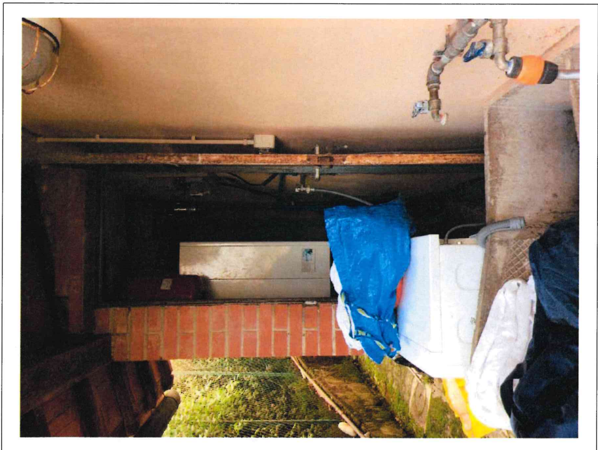
FOTO 16: Dettaglio della Centrale Termica - Zona Lavatrice.
