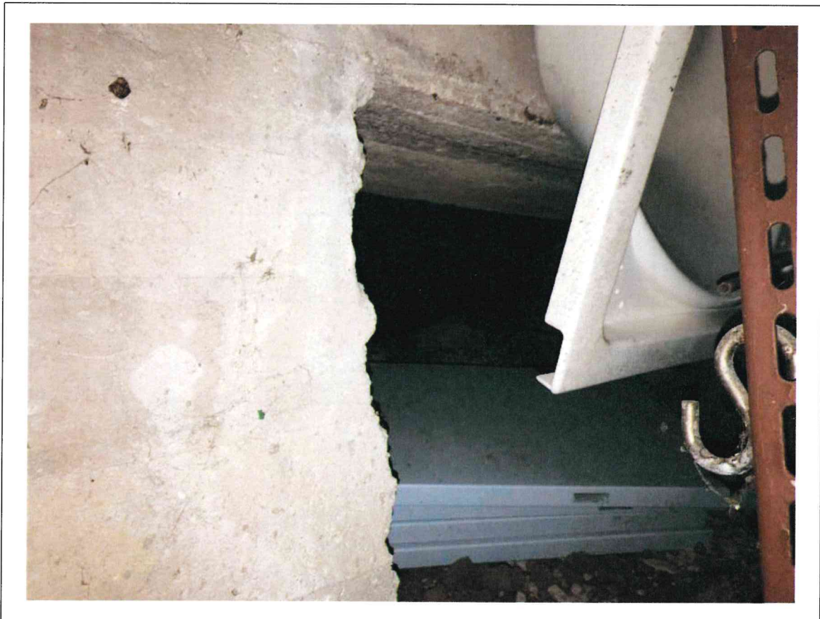
FOTO 12: Vista del vano porta realizzato per il collegamento con il Rispostiglio interrato: quest'ultimo mai realizzato.
