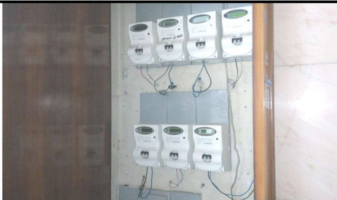
FOTO 98 – VISTA CONTATORI ENEL – COMPLESSO RESIDENZIALE
