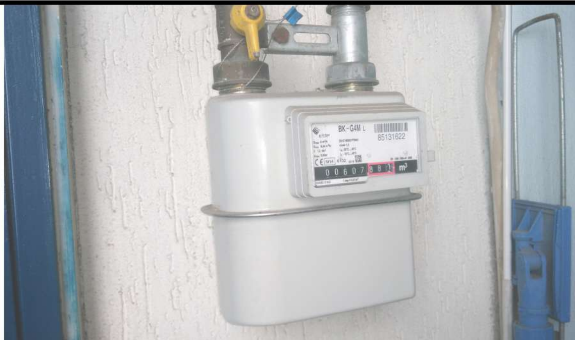
FOTO 99 – VISTA CONTATORE GAS – UNITA TIPICA RESIDENZIALE
