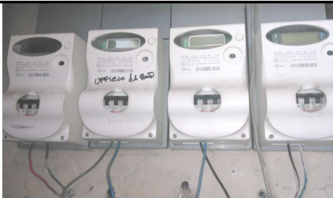
FOTO 97 – VISTA CONTATORI ENEL – COMPLESSO RESIDENZIALE
