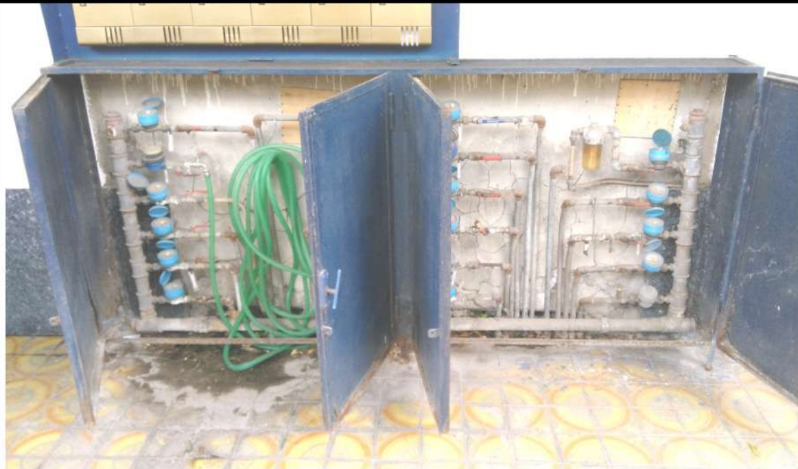
FOTO 103– VISTA POZZETTO IDRICO – COMPLESSO RESIDENZIALE
