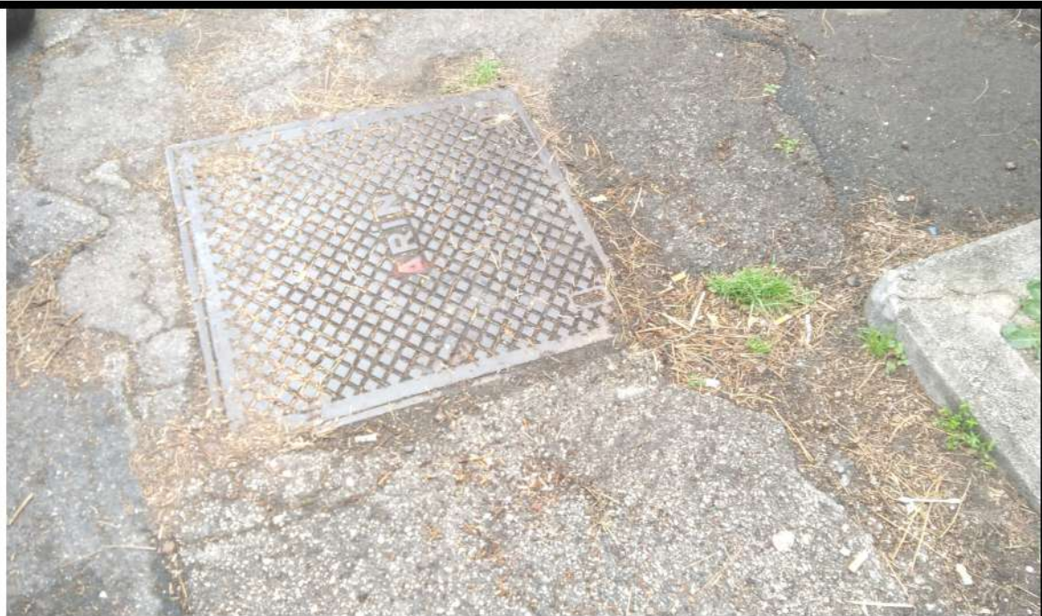
FOTO 101– VISTA POZZETTO IDRICO – COMPLESSO RESIDENZIALE
