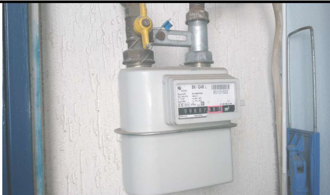
FOTO 100– VISTA CONTATORE GAS – UNITA TIPICA RESIDENZIALE
