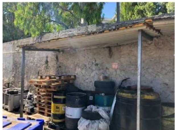
tettoia abusiva da demolire
