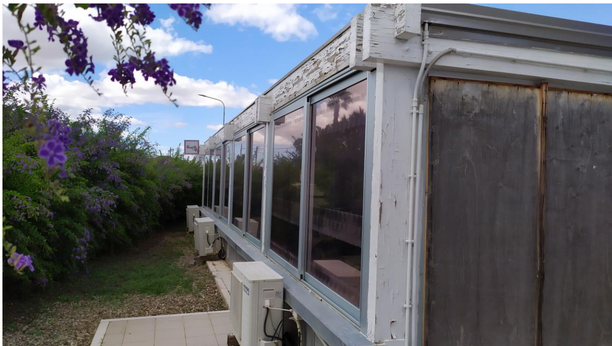
FOTO E.62: in evidenza, l'ampliamento abusivo della sala ristoro, insanabile, da rimuovere/demolire e l'antistante patio.
