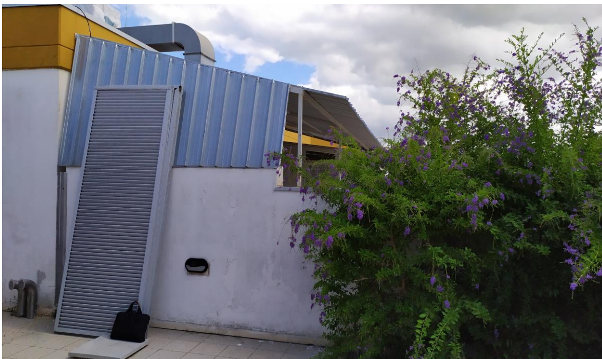
FOTO E.58: in evidenza, la tettoia precaria annessa alla zona cucina/servizi dell'Hotel.
