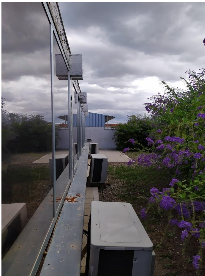
FOTO E.16: in evidenza, l'ampliamento abusivo della sala ristoro, insanabile, da rimuovere/demolire, ed il patio antistante.
