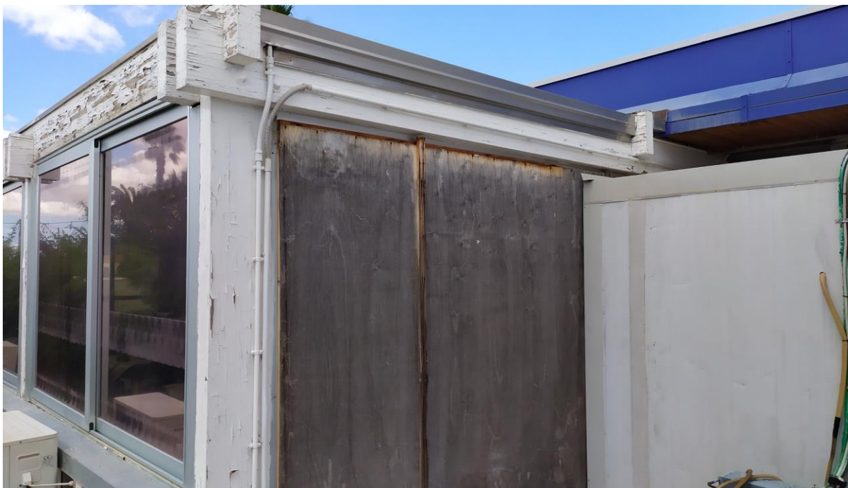
FOTO E.61: in evidenza, l'ampliamento abusivo della sala ristoro, insanabile, da rimuovere/demolire.
