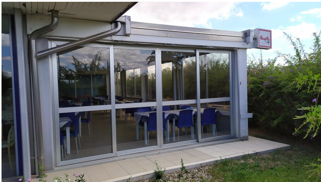
FOTO E.15: in evidenza, l'ampliamento abusivo della sala ristoro, insanabile, da rimuovere/demolire.
