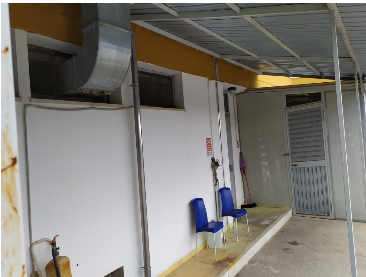
FOTO E.59: in evidenza, la tettoia ed il locale deposito precari annessi alla zona cucina/servizi dell'Hotel.
