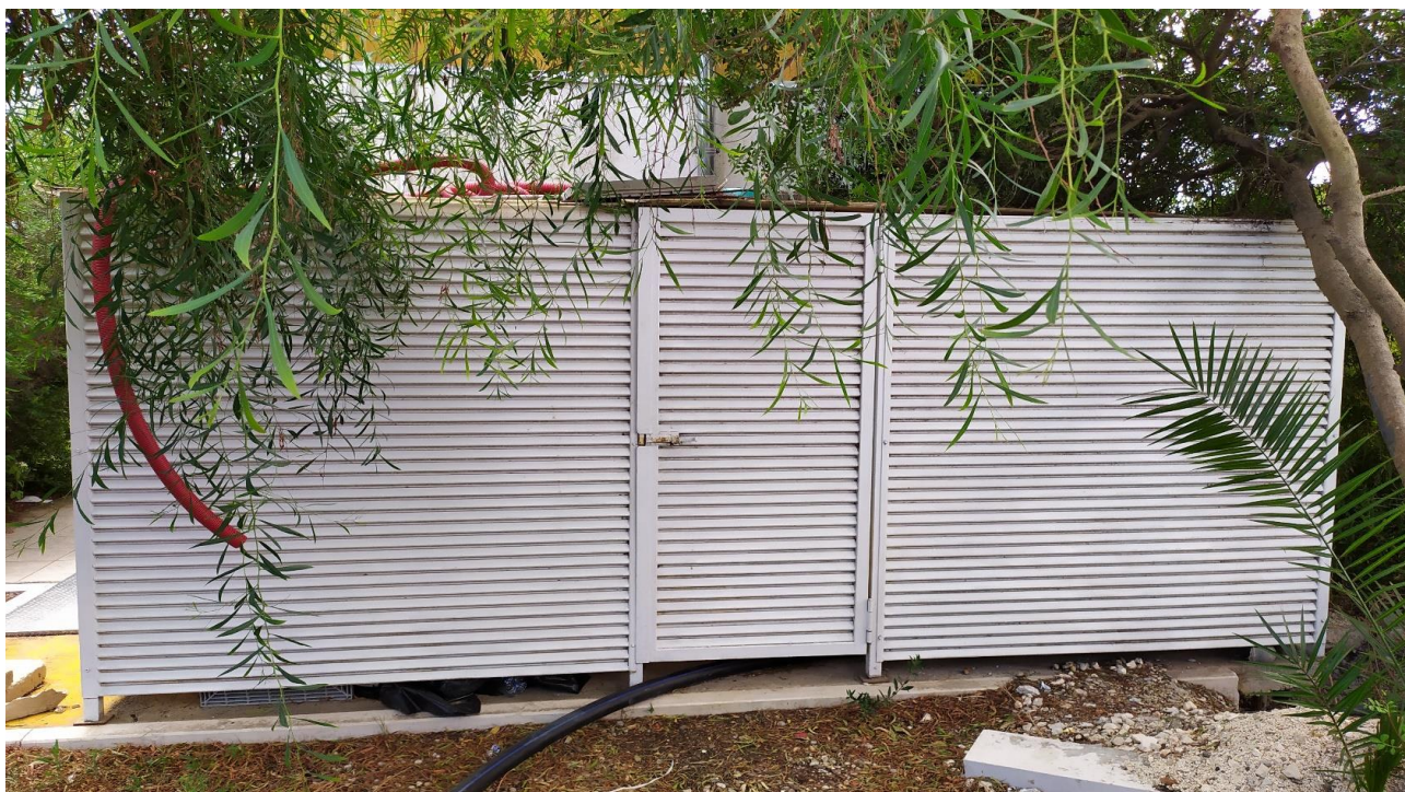
FOTO E.29: in evidenza, il vano tecnico per gli impianti d'autoclave ed antincendio.
