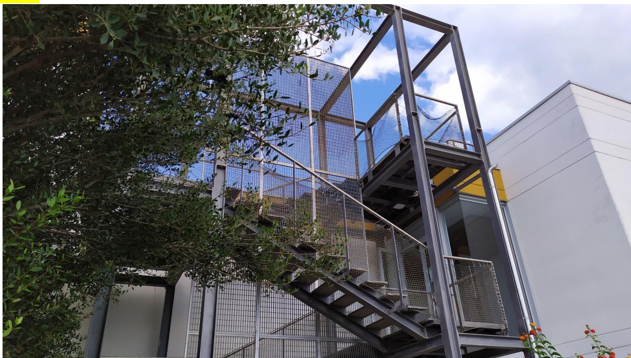
FOTO E.19: in evidenza, la scalinata esterna per l'accesso ai piani dell'Hotel, nonché di sicurezza.
