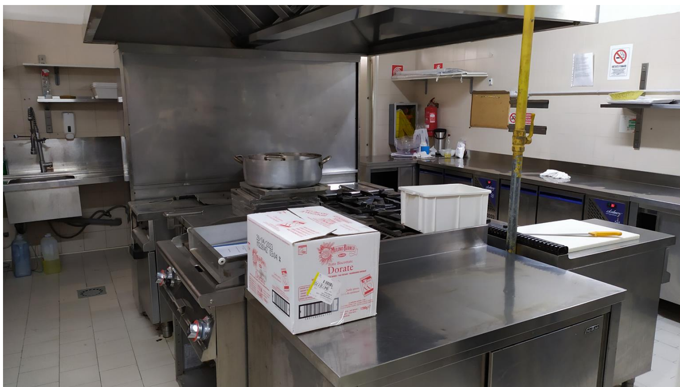
FOTO I.30: in evidenza, la cucina con i suoi impianti ed attrezzature varie.
