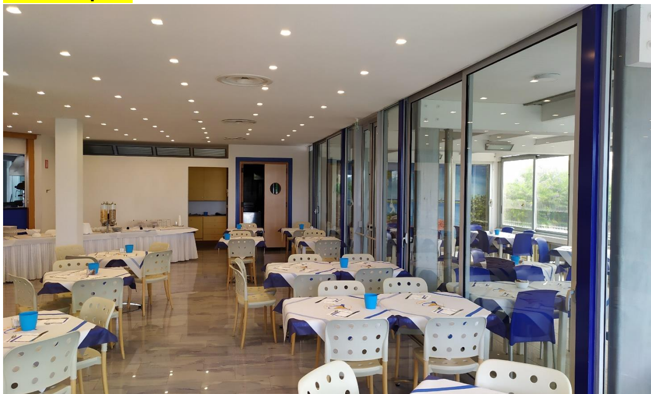
FOTO I.24: in evidenza, la sala ristoro e sullo sfondo la porta della cucina, a dx l'ampliamento della sala realizzato senza titolo edilizio, insanabile, da rimuovere/demolire.
