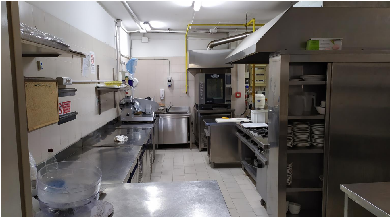
FOTO I.27: in evidenza, la cucina con i suoi impianti ed attrezzature varie.
