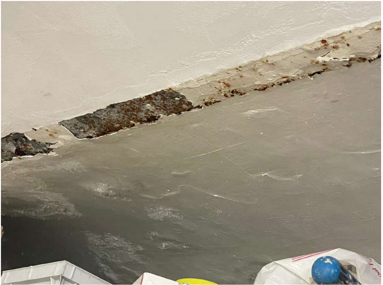
FOTO 14 – dettaglio degrado ferro della copertura in voltine
