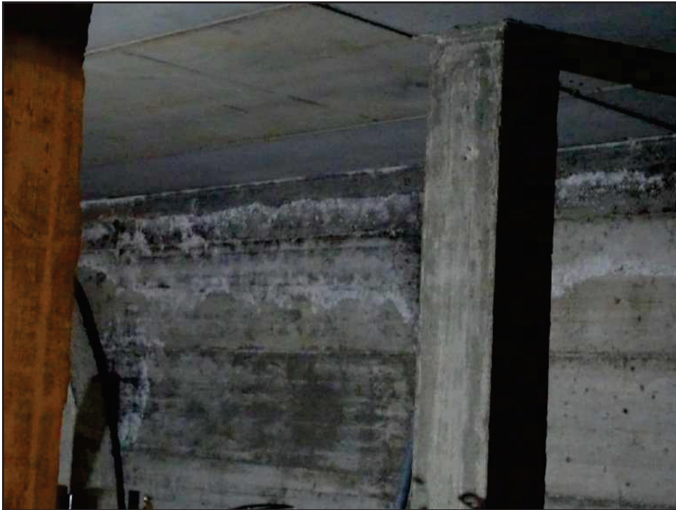
Particolare infiltrazioni parete nei locali subb. 22, 23
