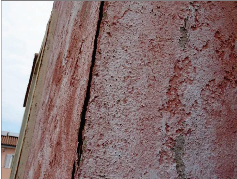
Particolare lesioni intonaco della muratura esterna.
