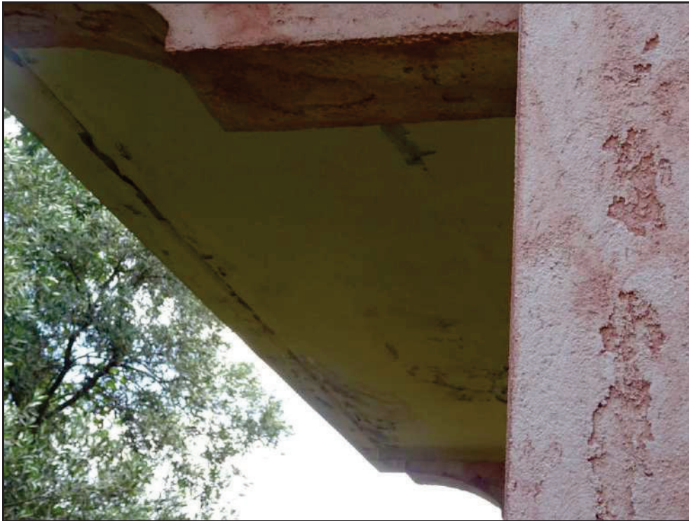
Particolare esfoliazioni tinteggiatura sul soffitto della veranda coperta lato nord.
