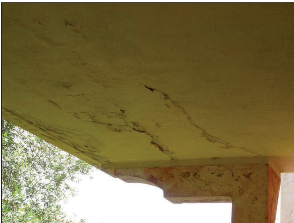
Particolare esfoliazioni tinteggiatura sul soffitto della veranda coperta lato nord.
