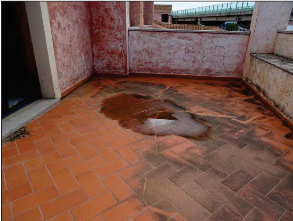
Ristagno acque piovane nel pavimento della terrazza rivolta a sud.
