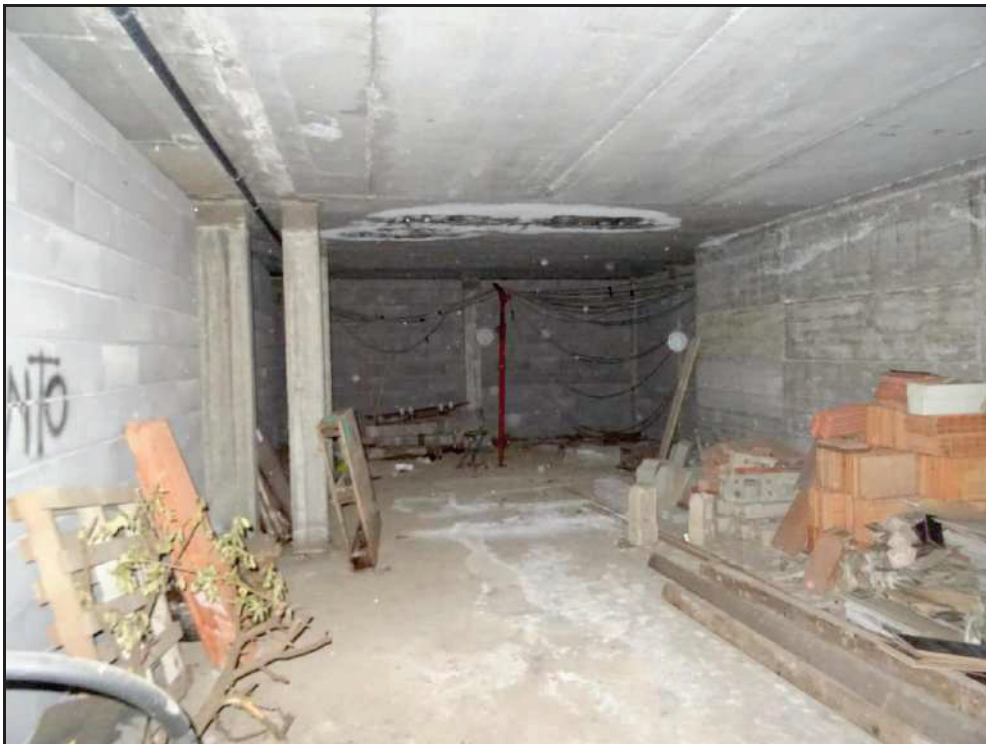
Particolare infiltrazioni nel locale sub 28.
