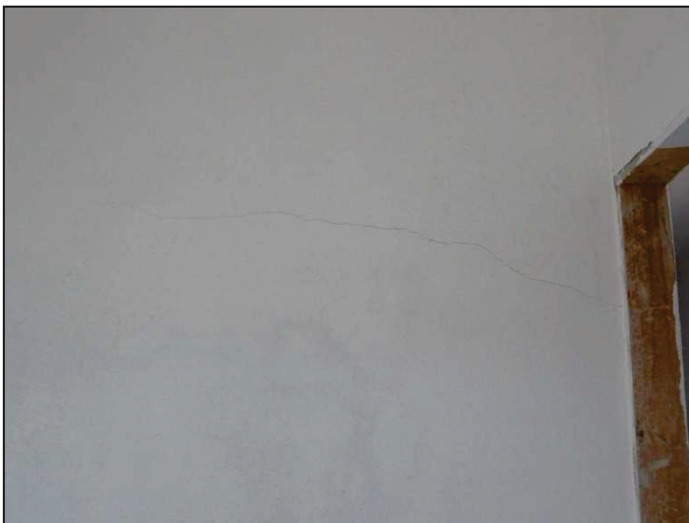
Particolare crepa di assostamento in una camera da letto.
