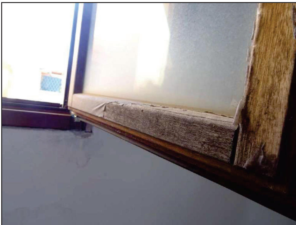
Particolare deterioramento infissi esterni più esposti.
