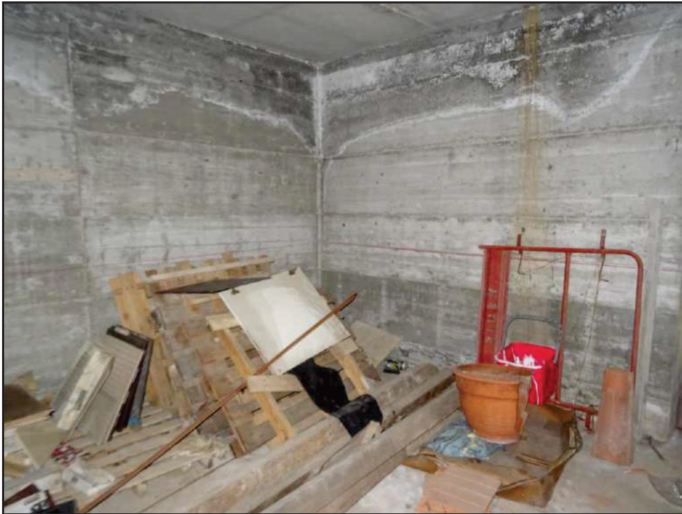
Particolare infiltrazioni nel locale sub 28.
