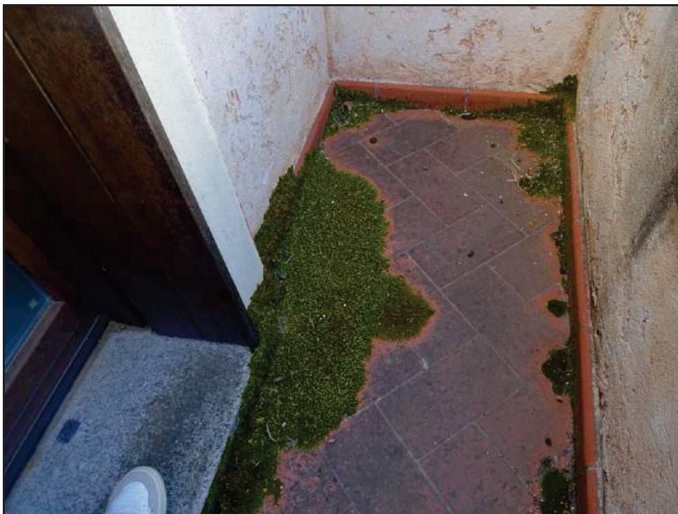
Particolare criticità nel balcone annesso alla camera da letto singola.
