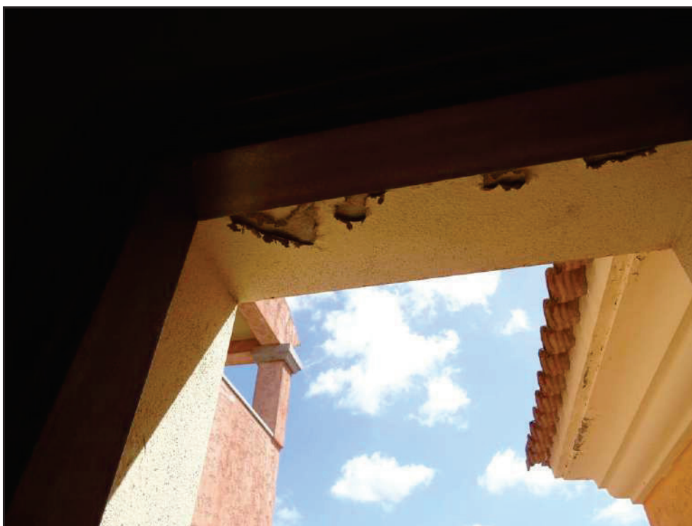
Particolare esfoliazione architrave finestra nel disimpegno al piano primo.
