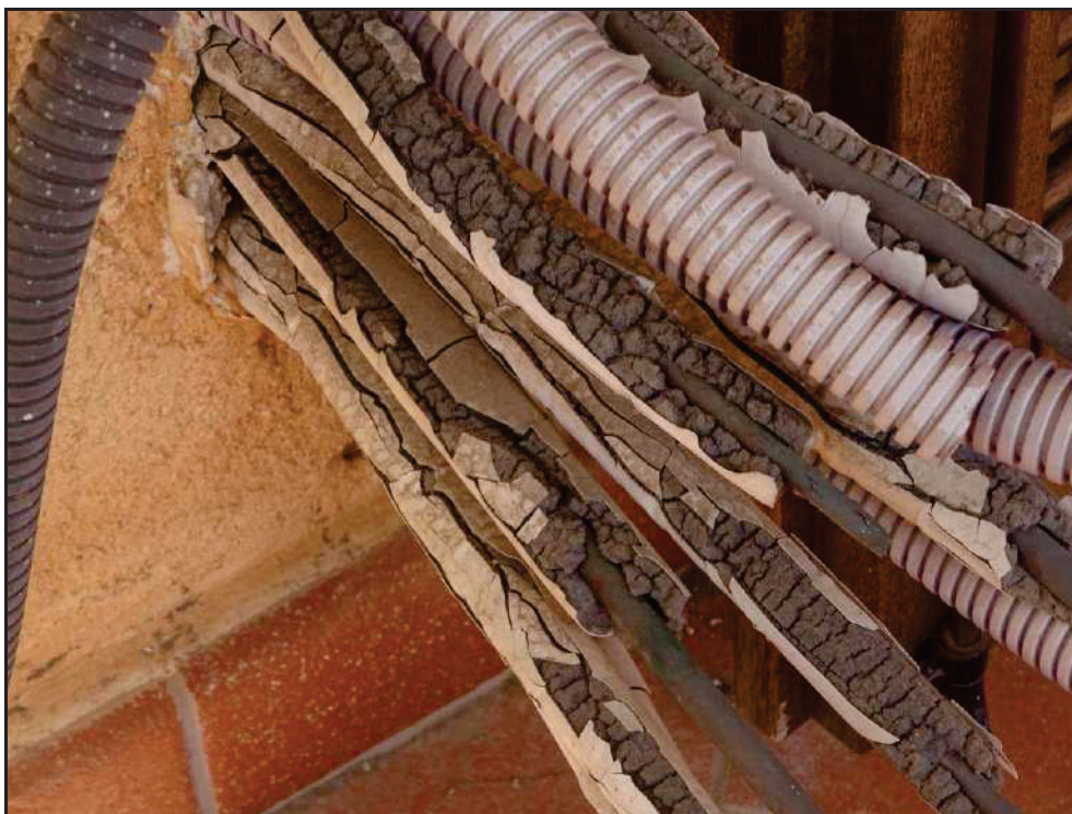
Particolare deterioramento di tubazioni impianto di condizionamento.
