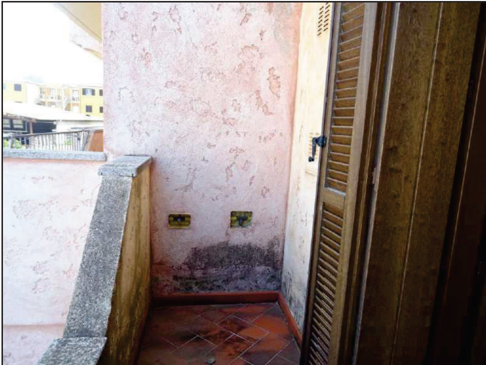
Stato di degrado nel balcone annesso alla camera padronale.
