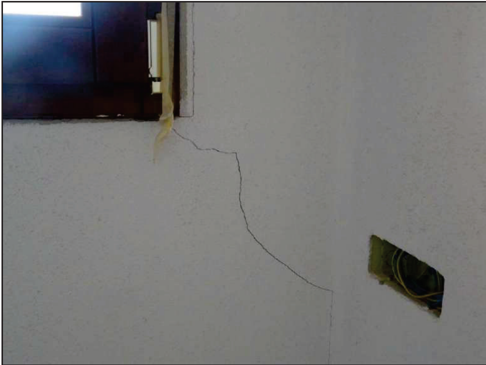
Particolare crepa di assestamento parete soggiorno.
