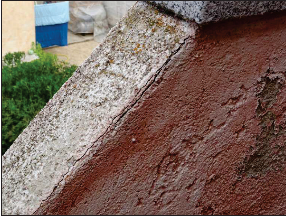
Particolare lesioni nel parapetto balconi.
