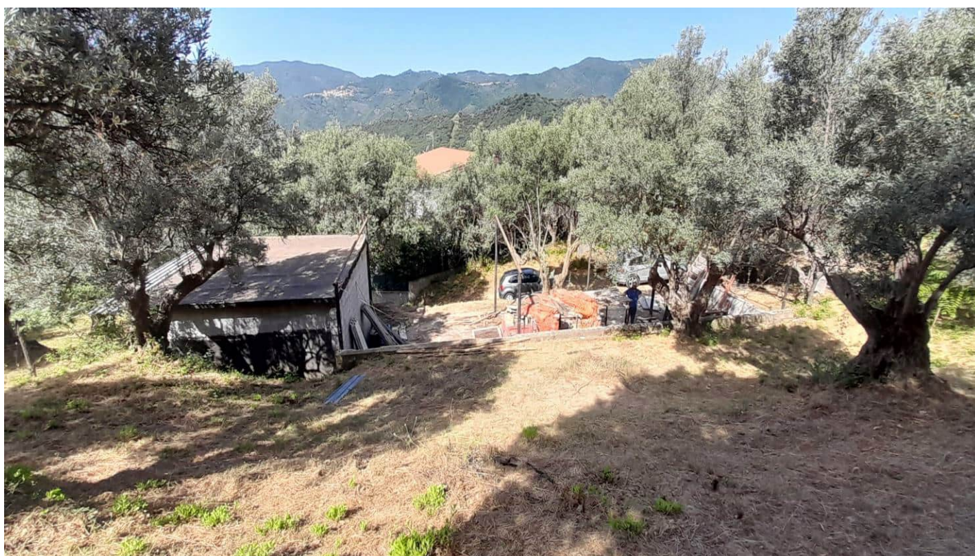
Foto n° 28 – Vista da Est del locale deposito censito nel N.C.E.U. al foglio 22 particella 435 sub 3 e della struttura della tettoia censita nel N.C.E.U. al foglio 22 particella 435 sub 4, con antistante terreno censito nel N.C.T. al foglio 22 particella 490
