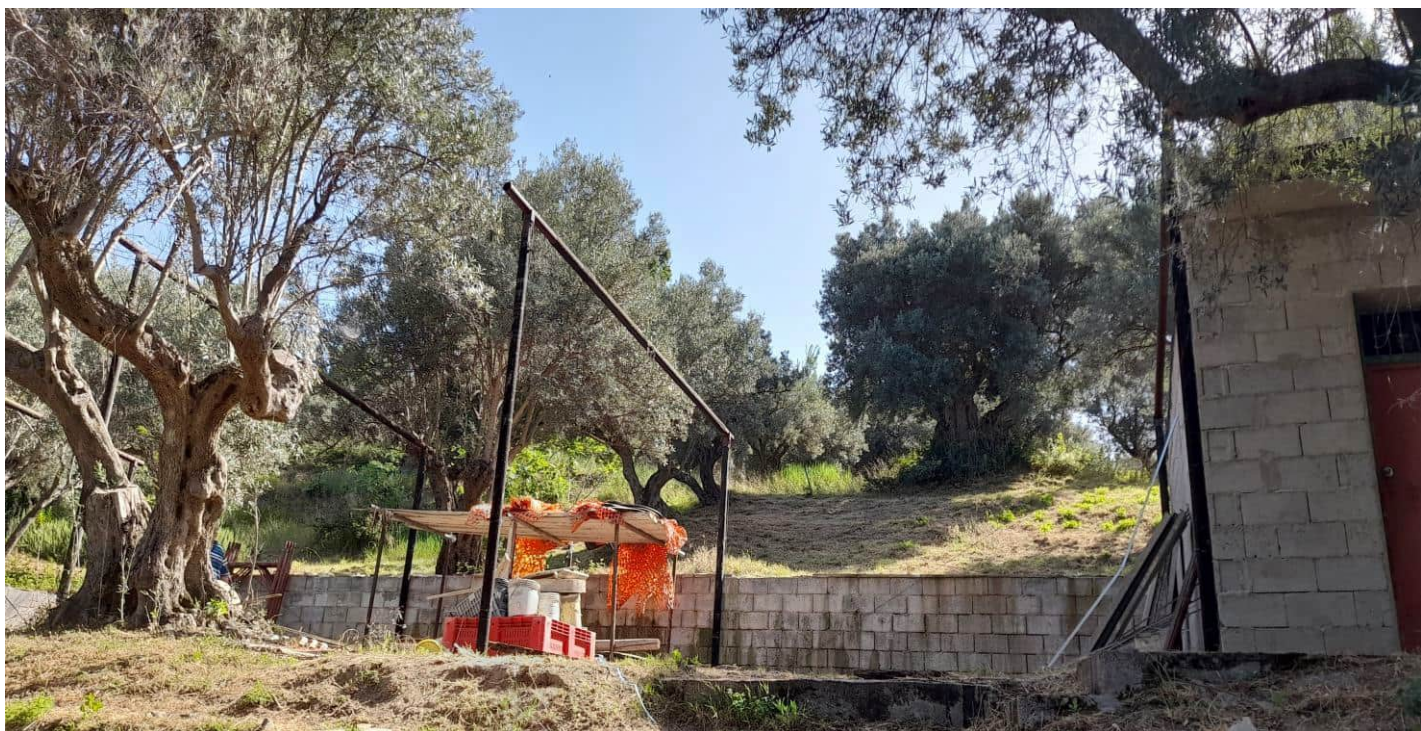
Foto n° 26 – Struttura della tettoia censita nel N.C.E.U. al foglio 22 particella 435 sub 4 – Vista da Ovest
