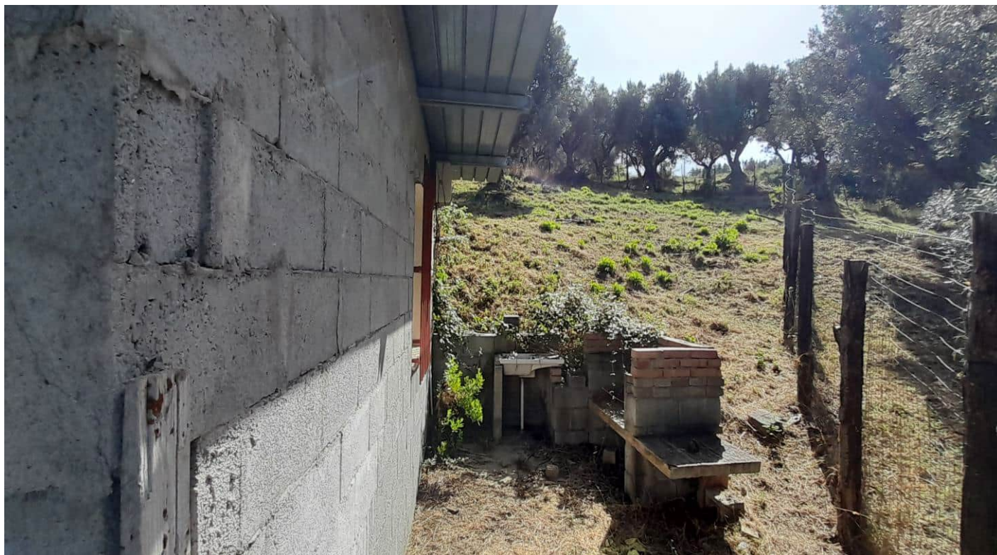
Foto n° 29 – Lavello presente sul terreno censito nel N.C.T. al foglio 22 particella 490 a ridosso della parete Sud-Est del locale deposito censito nel N.C.E.U. al foglio 22 particella 435 sub 3
