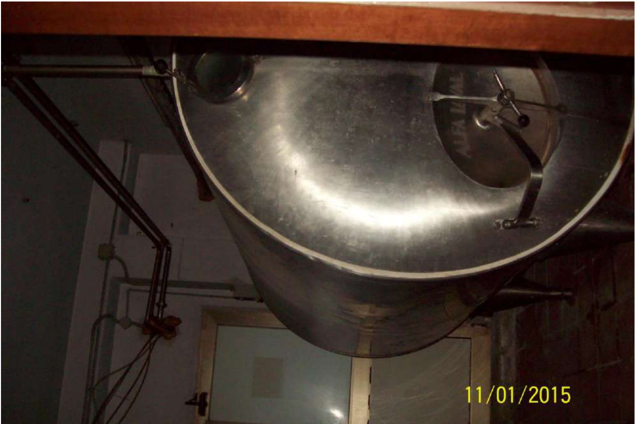
Impianto nei locali accessori al caseificio da regolarizzare attraverso sanatoria lotto n.3
