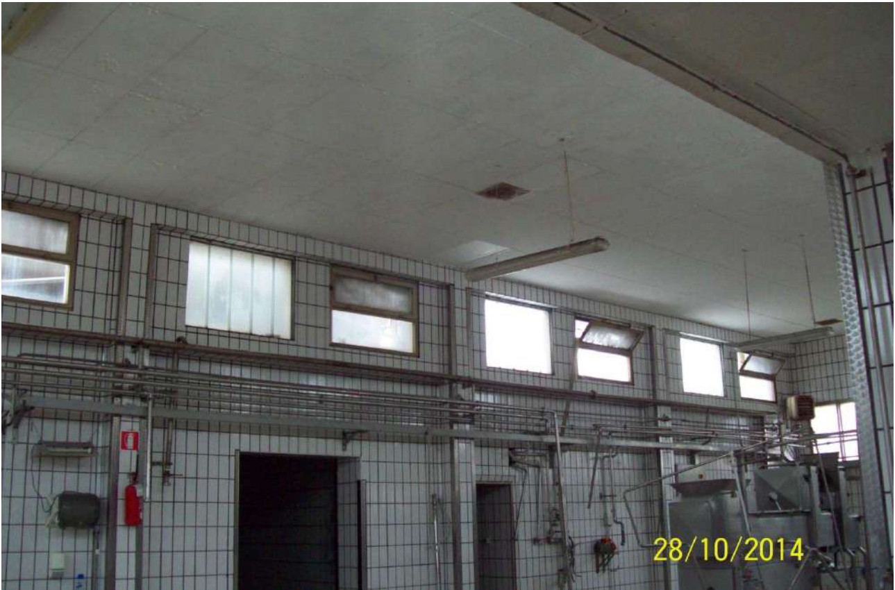
Vista interna del caseificio con gli impianti e l'assenza di macchine ed attrezzature. Lotto n.3
