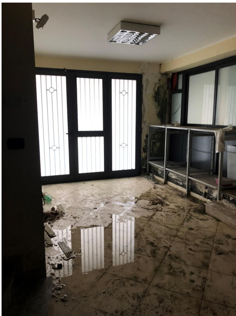
Presenza di acqua stagnante sul pavimento
