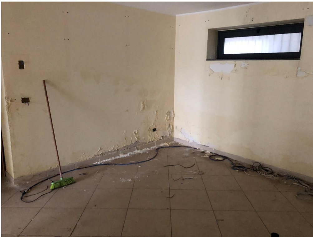
Efflorescenze negli ambienti del lotto n°2 adiacente a causa della stagnazione dell'acqua presente sul pavimento
