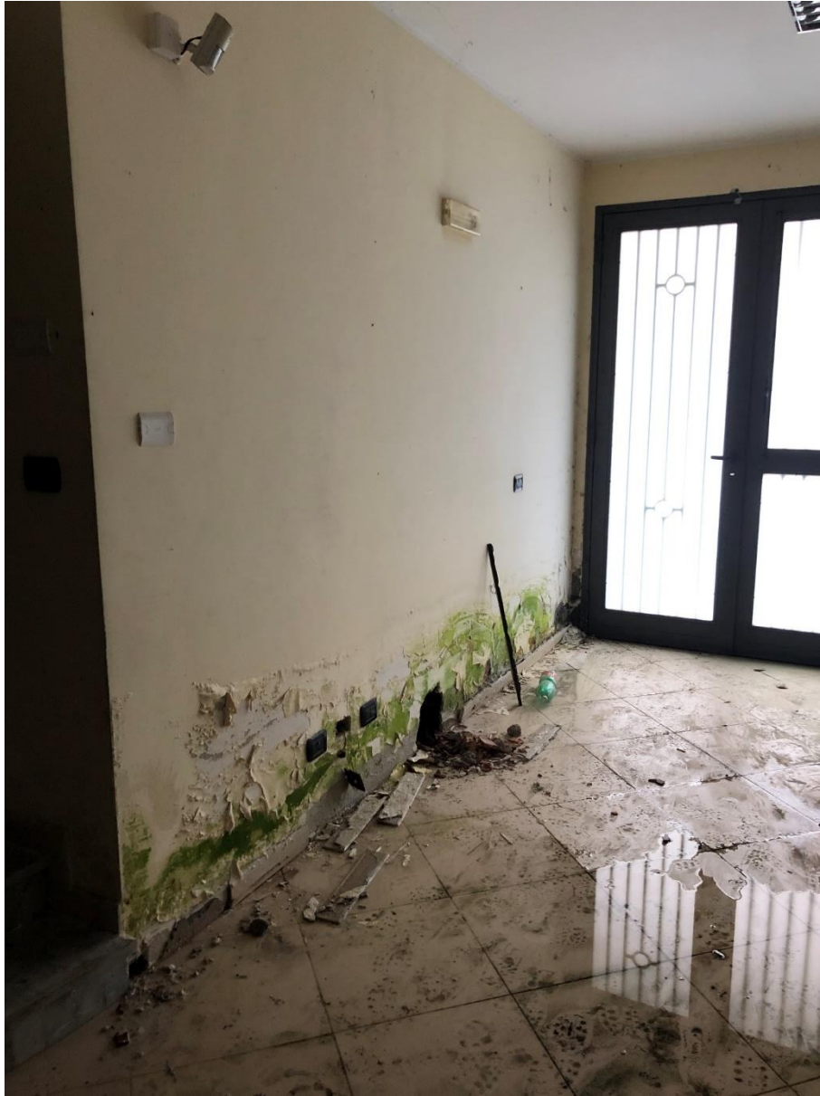
Degrado dell'intonaco (muffa e compromissione dello strato di finitura) e distacco del battiscopa
