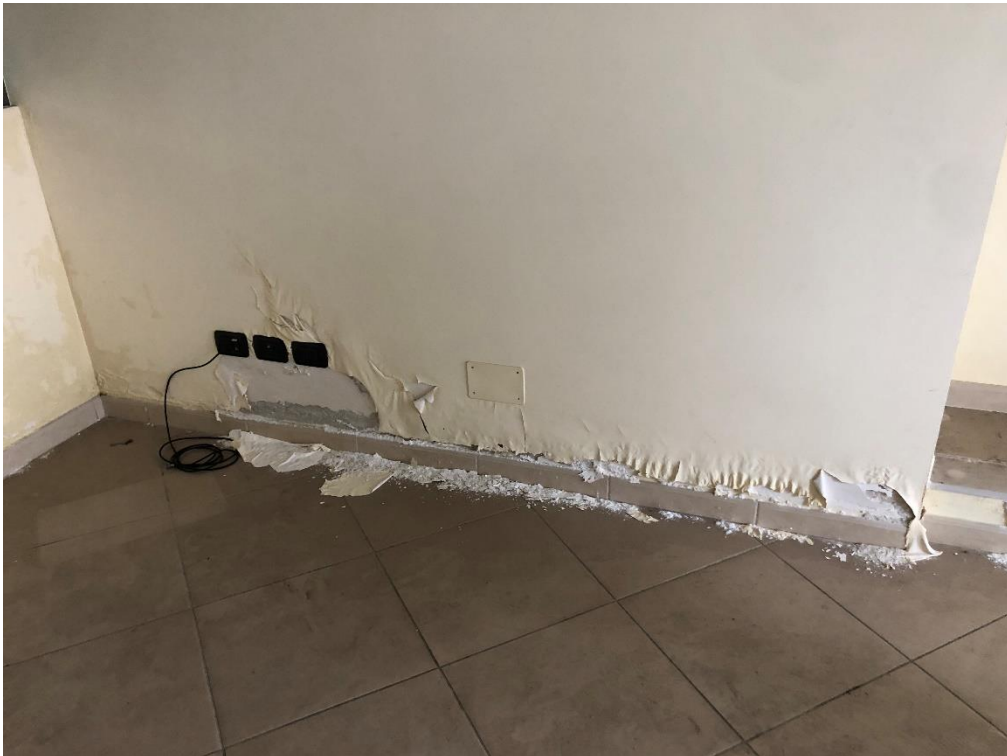
Efflorescenze negli ambienti del lotto n°2 adiacente a causa della stagnazione dell'acqua presente sul pavimento
