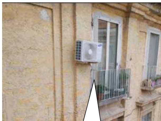
Macchina esterna sul terrazzino che alimenta split in cucina
