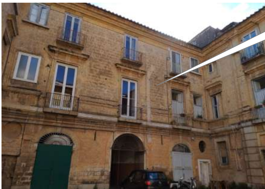
Facciata interna intonaco degradato
