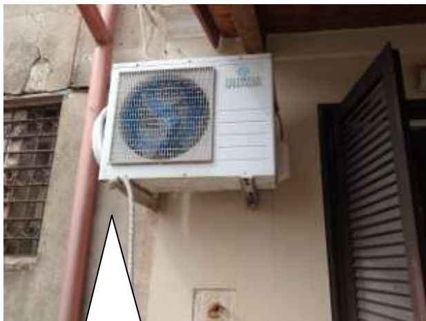
Macchina esterna sul terrazzino che alimenta split in camera da letto 2
