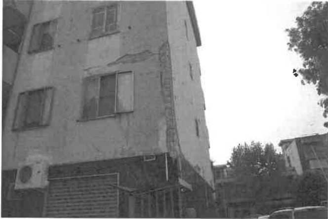
Foto n°7 Cadute di intonaco dalle pareti esterne dell'edificio
