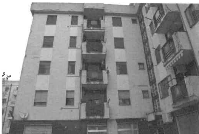
Foto n°5 Sofferenze negli intonaci di facciata
