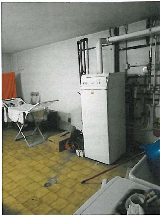
Foto 6 – Seminterrato - Centrale Termica
