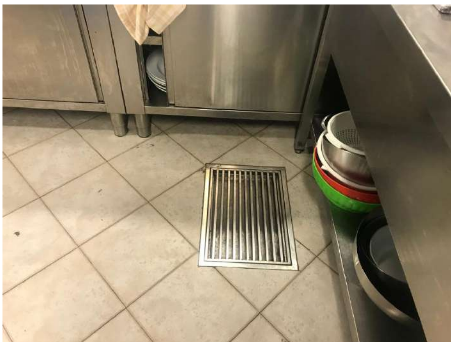
Foto n.8 Locale ristorante bar pizzeria A.1: particolare cucina
