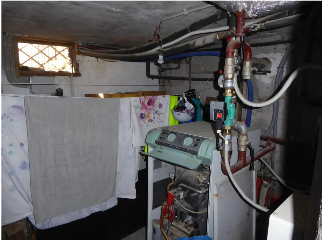
FOTO 13 – CENTRALE TERMICA SUB. 6 PIANO SEMINTERRATO
