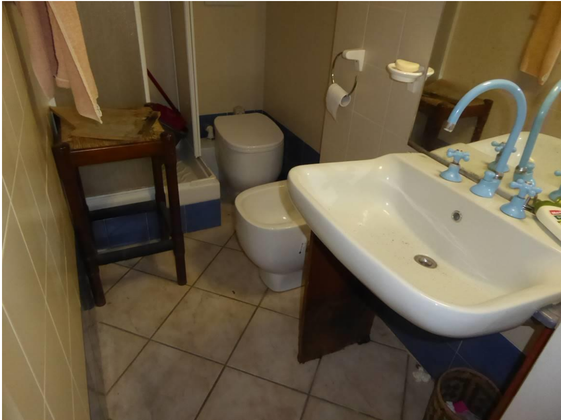
FOTO 11 – BAGNO SUB. 6 PIANO SEMINTERRATO
