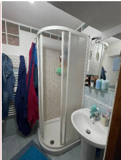
Bagno da ripristinare piano terra
