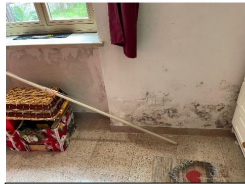
Infiltrazioni piano terra
