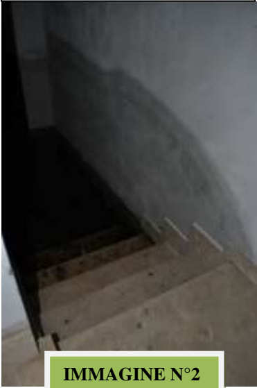
VANO SCALA ALLAGATO
