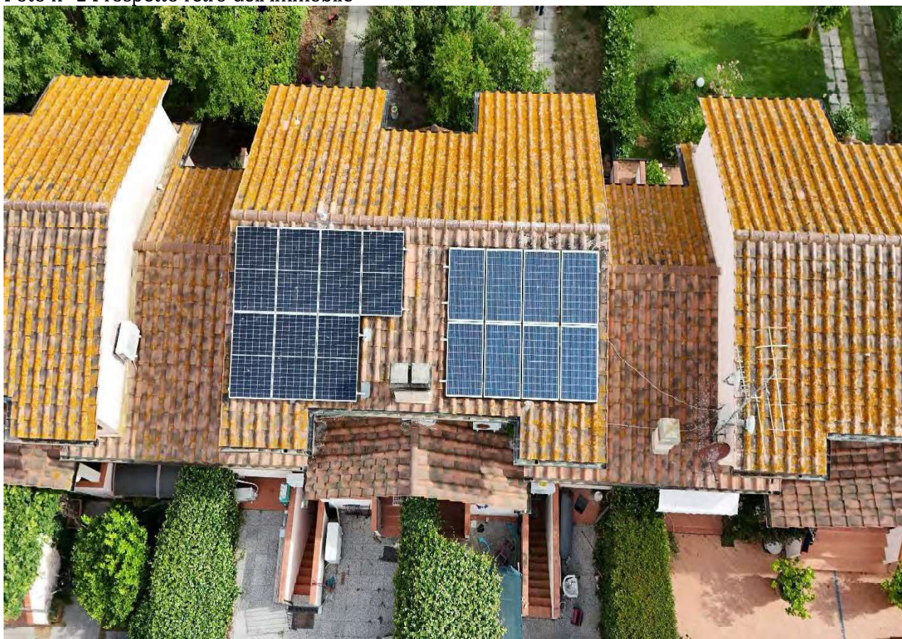
Foto n° 3 Pannelli solari, falda tetto sul retro dell'immobile
