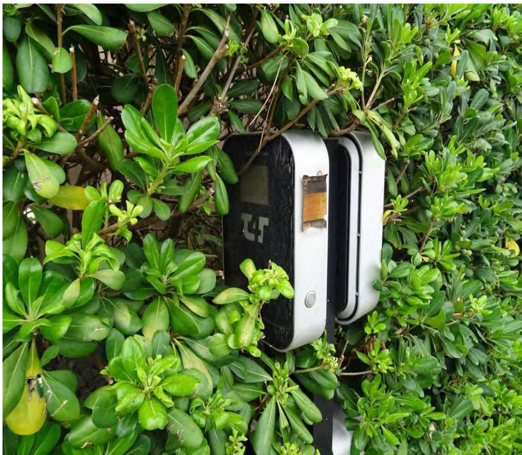
Foto n° 8 Colonnina Ricarica auto elettriche
