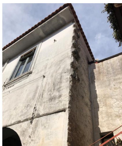
ESTERNO TERMINALE SUB 15/LATO CORTE
