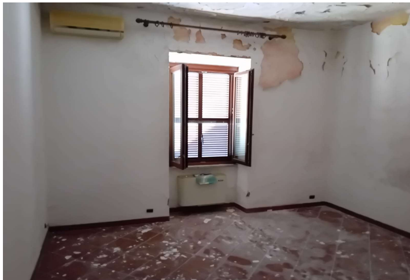
la stanza 2 - con infiltrazioni dal solaio di copertura
