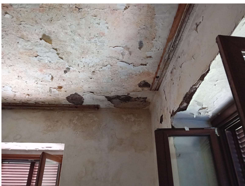
soggiorno - infiltrazioni dal solaio di copertura
