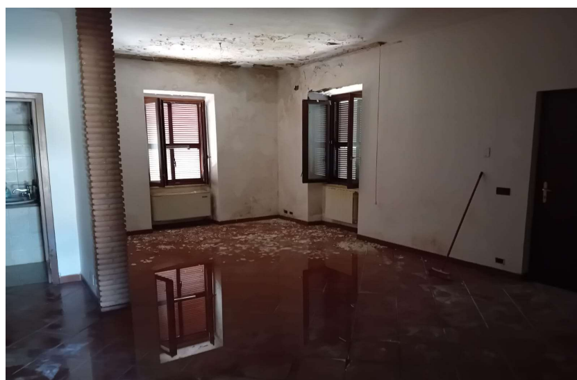
il soggiorno in stato di degrado per infiltrazioni dal solaio di copertura
