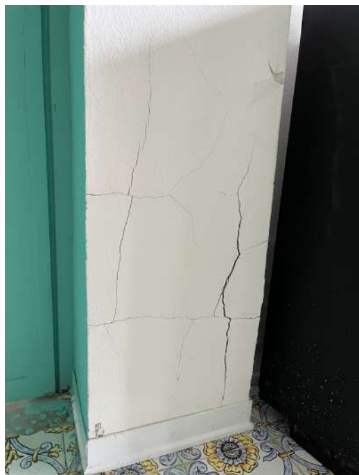
Foto 25 - Lesioni su pilastro
