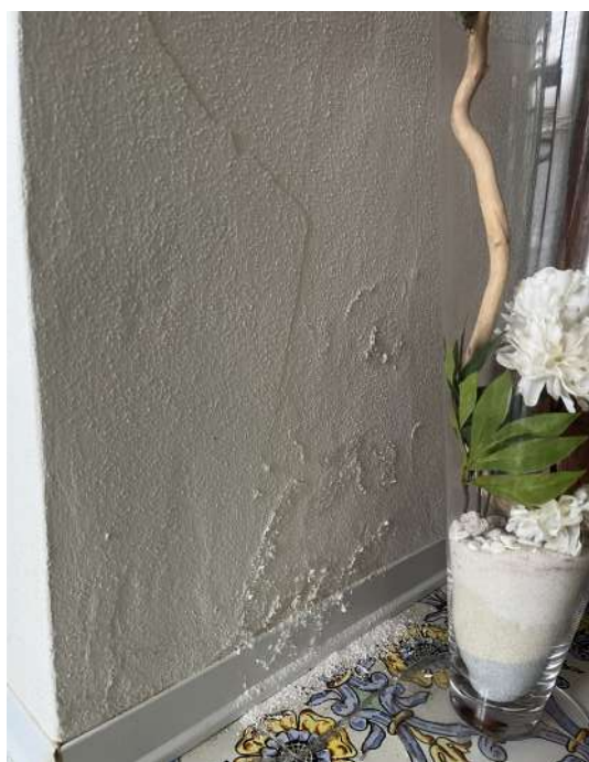
Foto 27 - Efflorescenze nella parte basamentale
