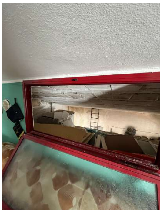
Foto 52 - Finestra su sottotetto
