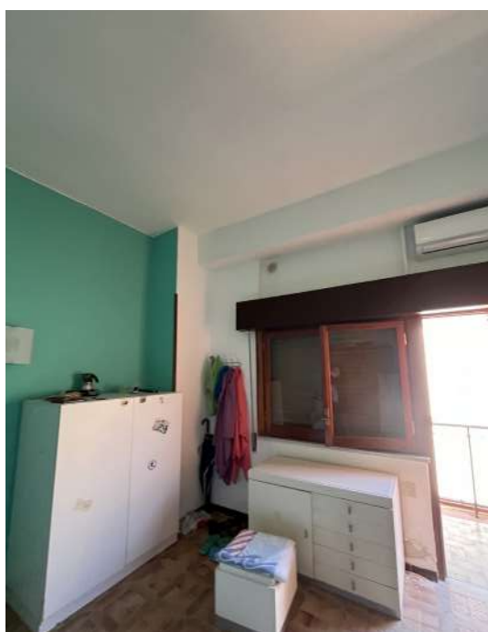
Foto 31 - Vano a debito a Camera 2 (piano primo)
