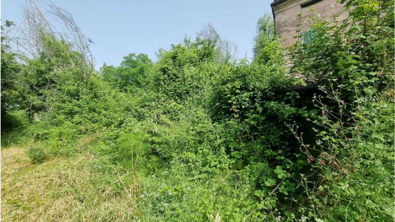
Foto 4 - da documentazione fotografica effettuata in loco durante il sopralluogo (accessorio infestato da vegetazione e non rilevabile)
