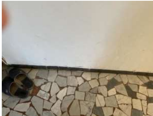
particolare battiscopa e pavimentazione danneggiata
