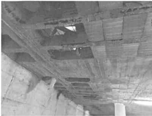
Foto 35 – Le "prese d'aria" sul soffitto
