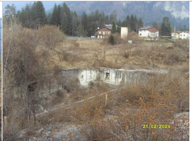
Fabbricato oggetto di demolizione non completamente demolito
