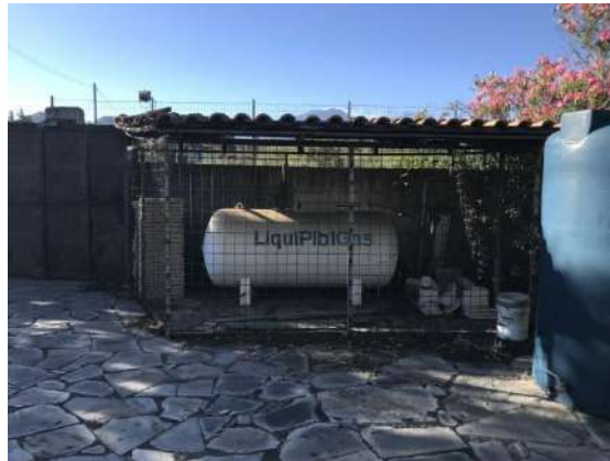
Struttura precaria con all'interno il serbatoio GPL a servizio dell'adiacente villa part.321
