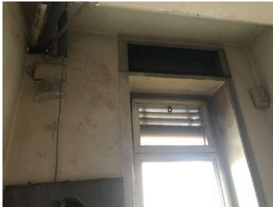
Patologie da umidità e riparazioni nella parete est
