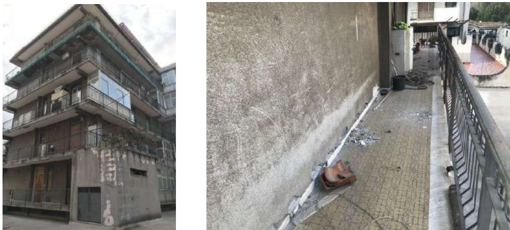
Stato di manutenzione generale del fabbricato con evidenti degradi dei frontalini e degli intonaci in generale
