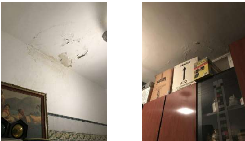
Patologie da umidità nei soffitti e pareti di wc e cucina
