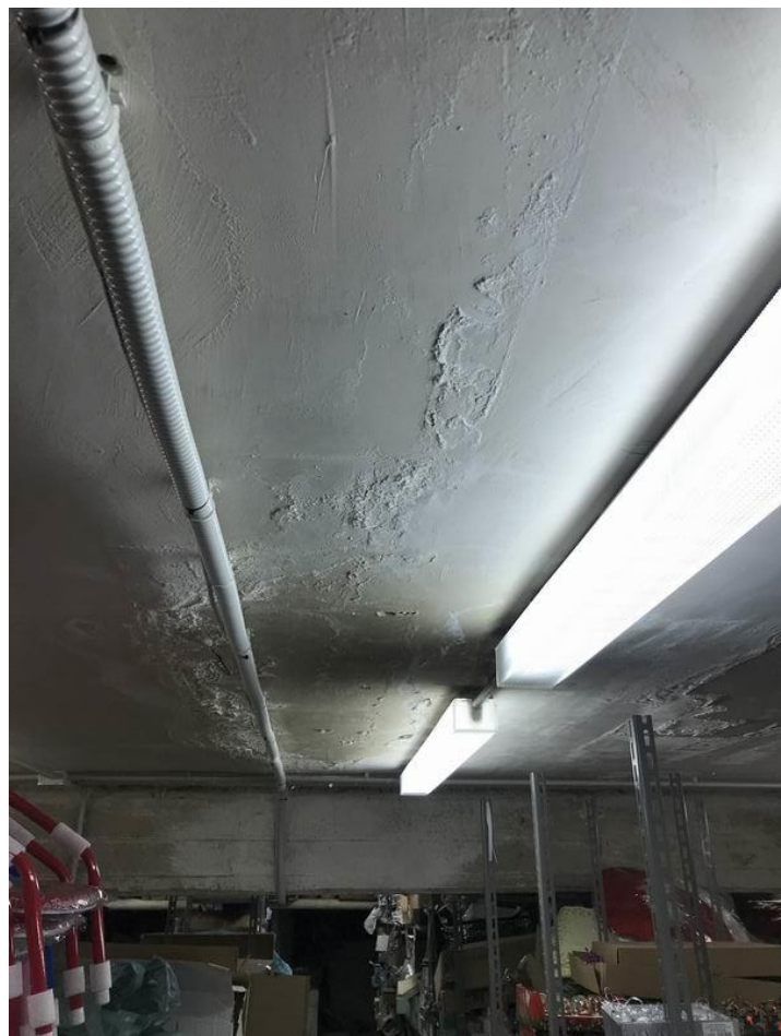
Particolari delle infiltrazioni provenienti dal sovrastante terrazzo (alieno)
