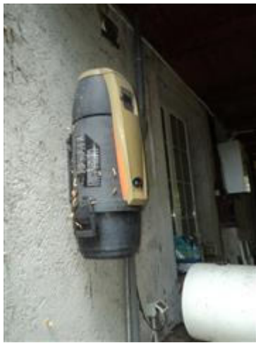
Impianto di aspirazione e caldaia PT.
