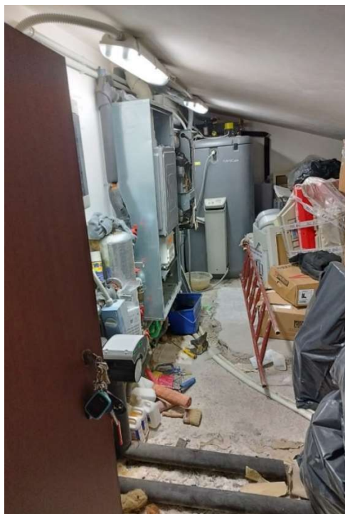
Foto 12 – Deposito piano 6° - Vano tecnico con pompa di calore
