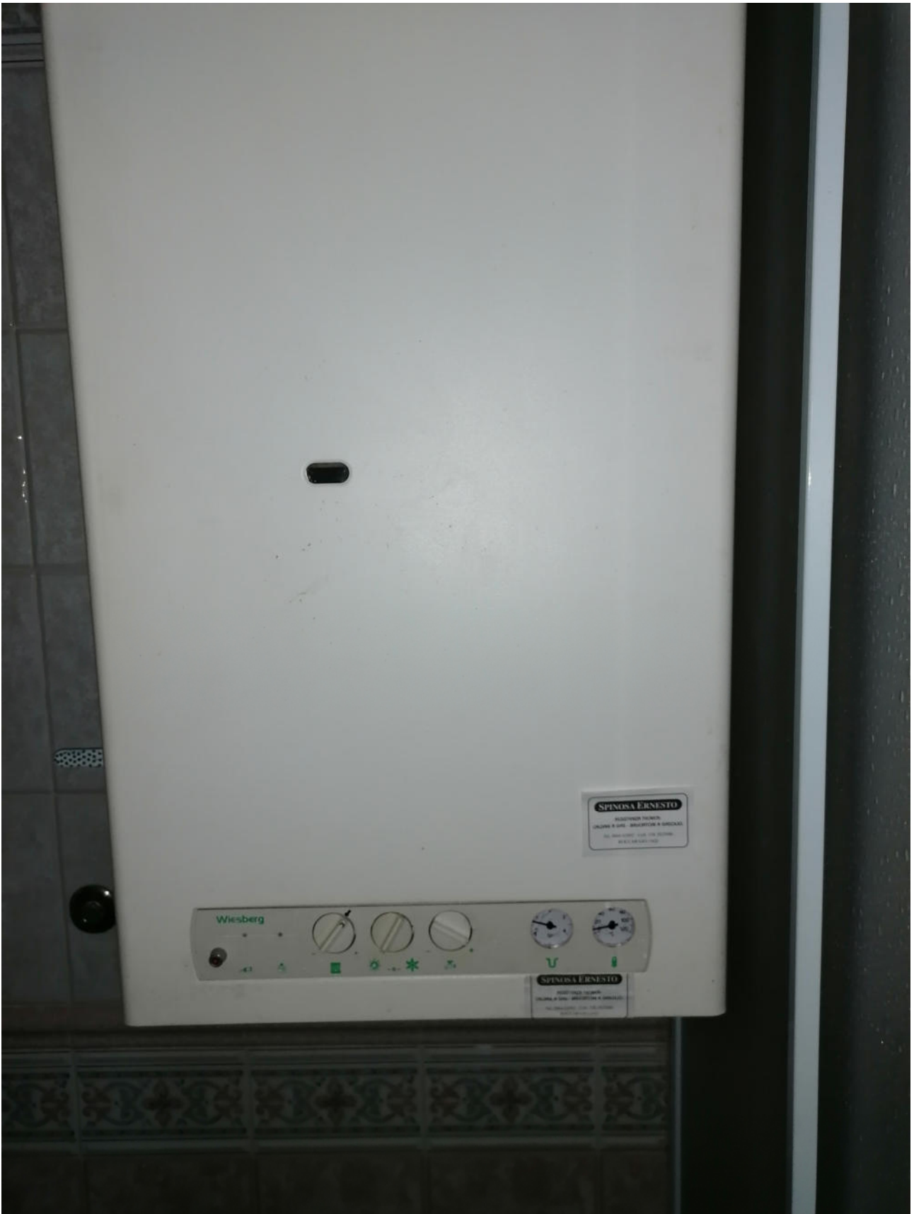
Foto 7 – Bagno, particolare della caldaia
