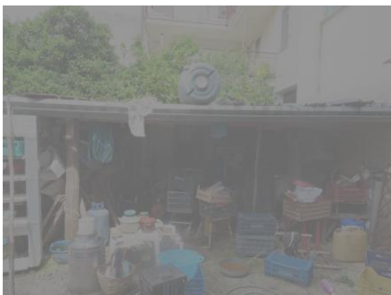
Tettoia fatiscente da demolire
