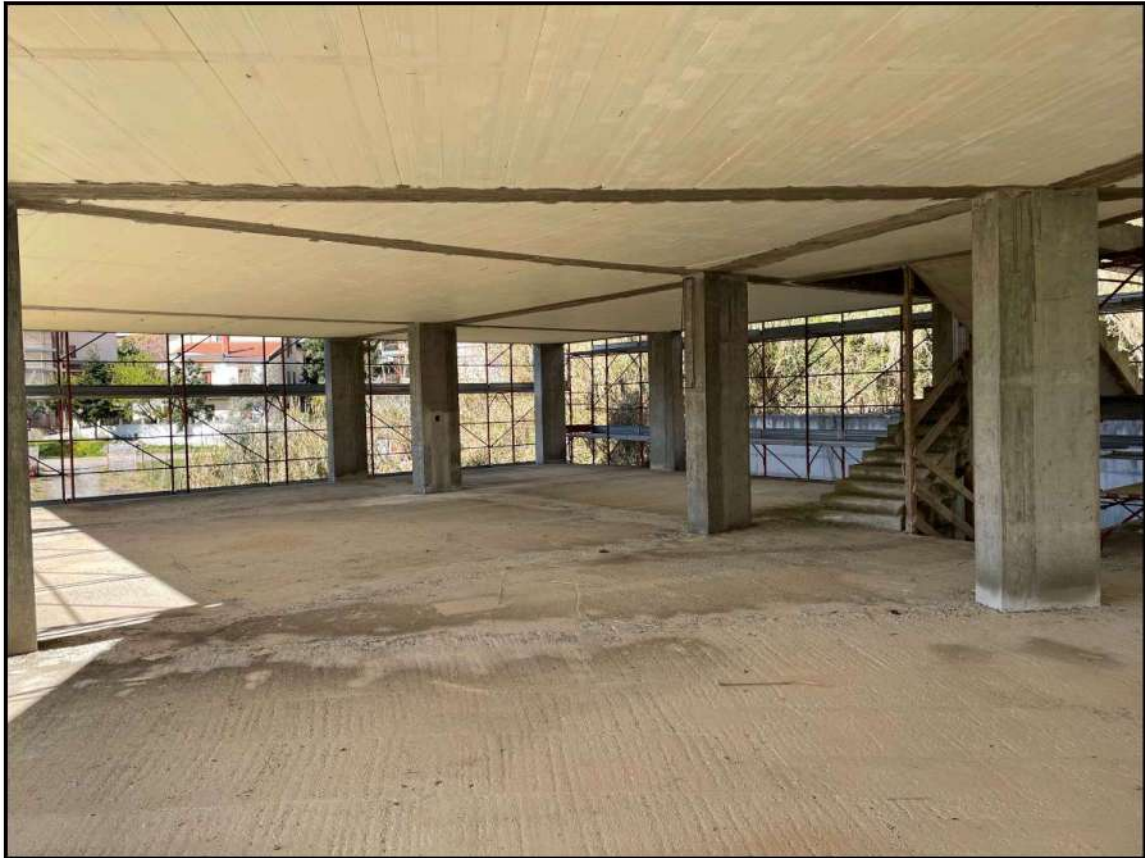
FOTO 7: Altra vista interna del fabbricato non ultimato
