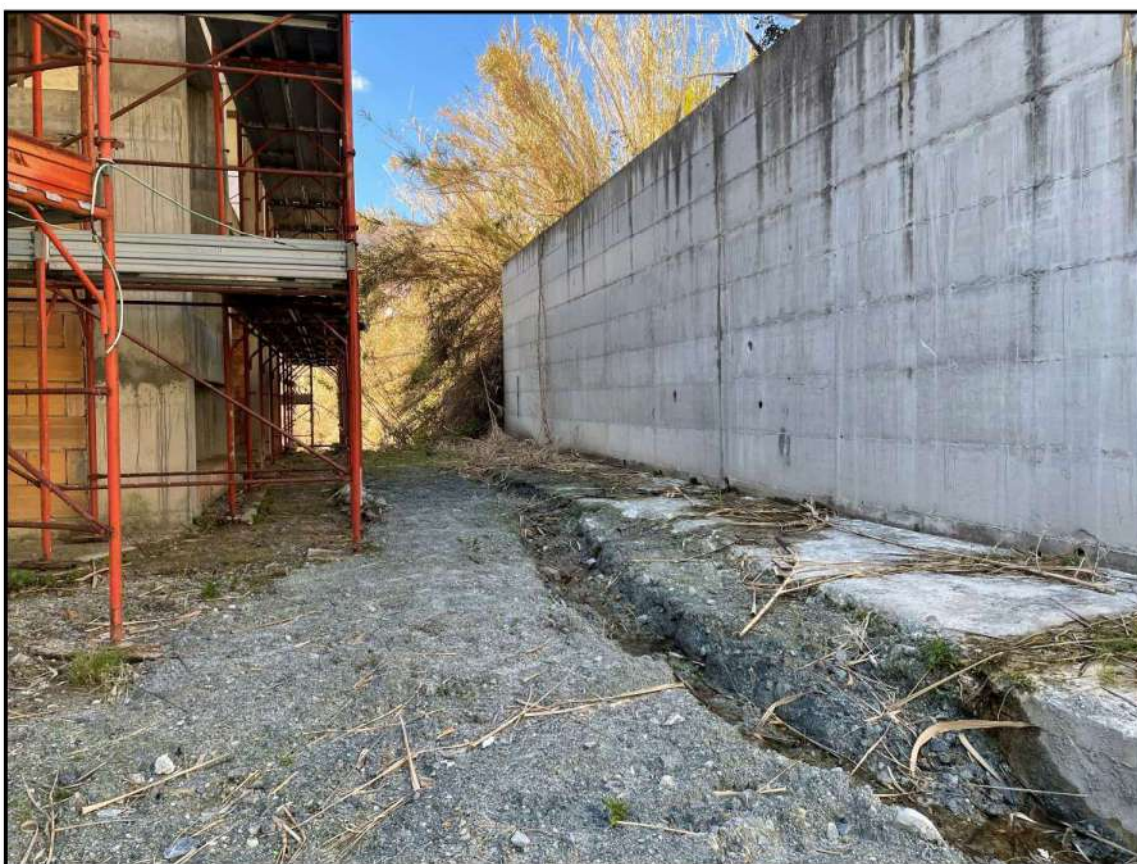
FOTO 4: Vista del muro in c.a realizzato lungo il confine nord al piede della scarpata
