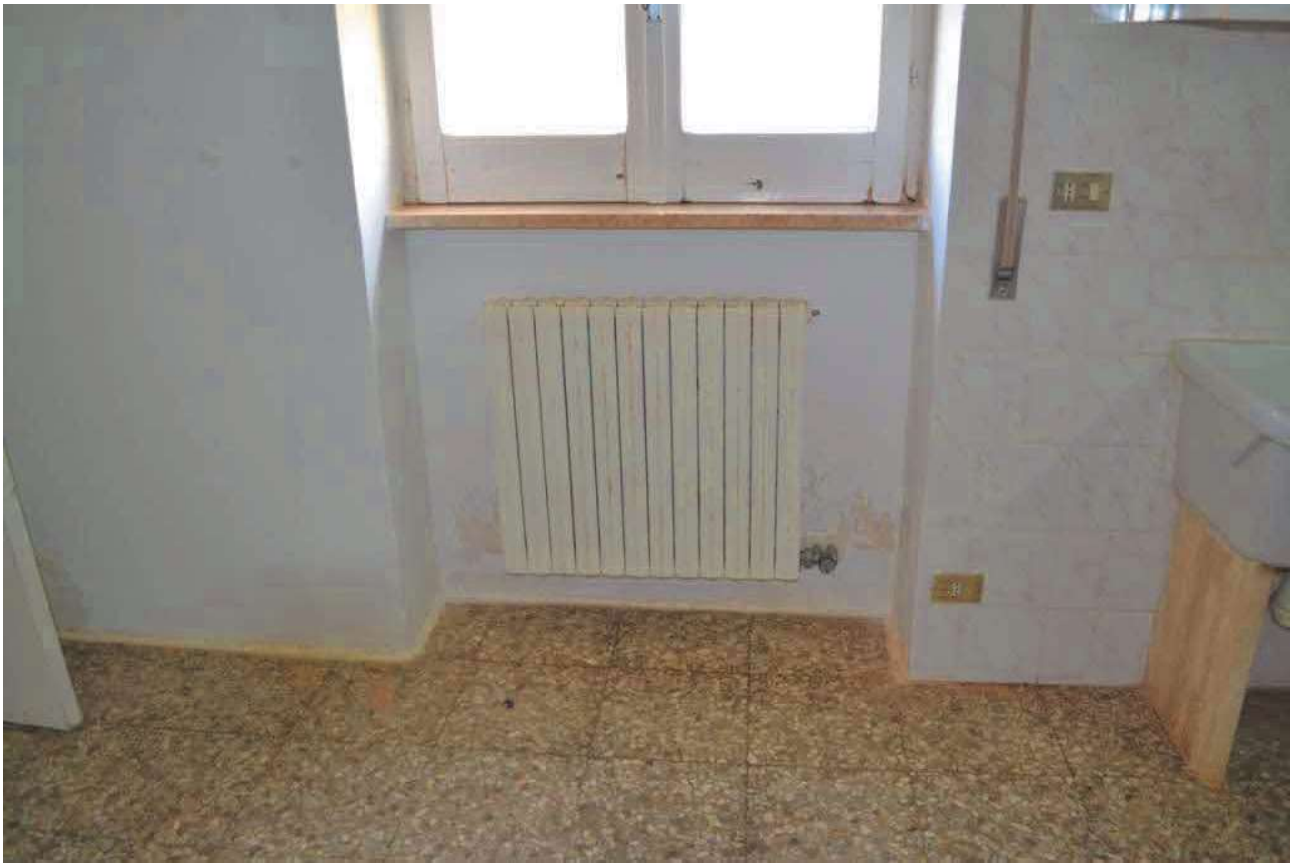
Pannello radiante in ghisa e macchie di risalita capillare
