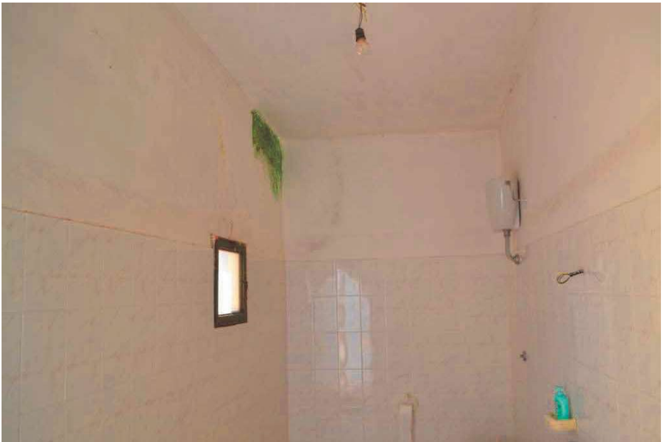
Macchie di umidità e muffa nel bagno con accesso dall'esterno
