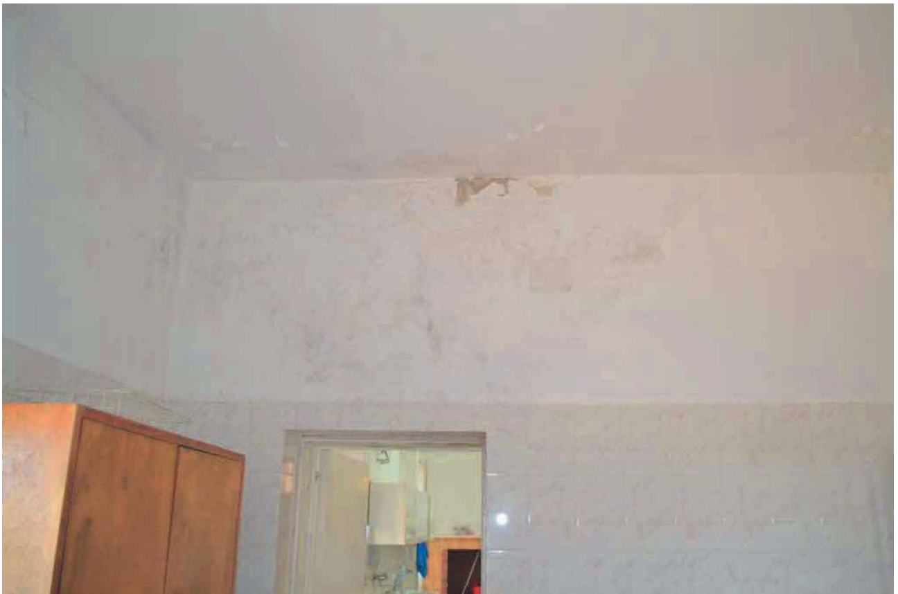
Evidenti macchie di umidità derivanti dal solaio
