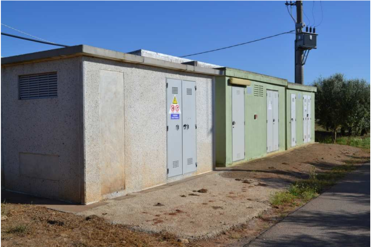
Vista della cabina, come meglio descritta posta accanto alle altre due in prossimità delle serre
