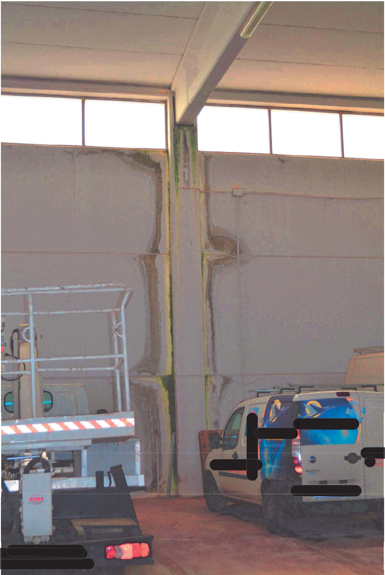
Macchie di umidità in prossimità del pilastro
