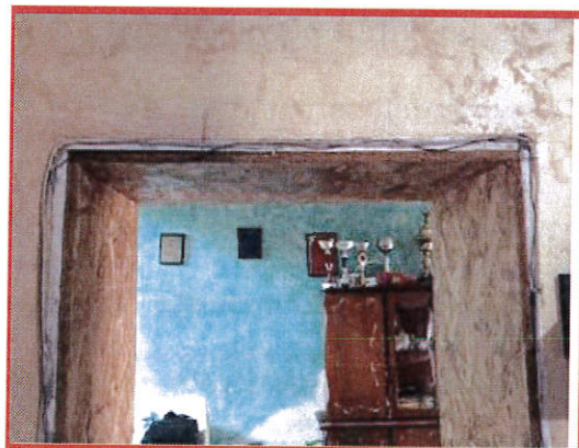
Foto 14– Cavi elettrici scoperti pendenti.
