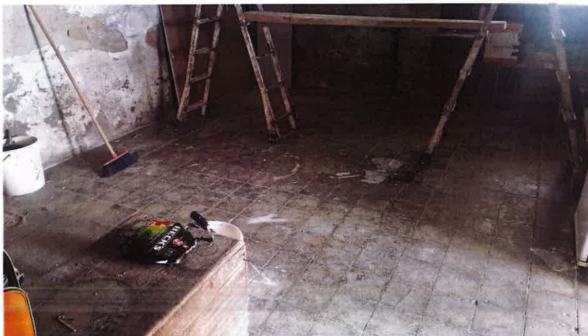
Foto 8 – Pavimentazione interno abitazione (A1) contrada Lavanche
