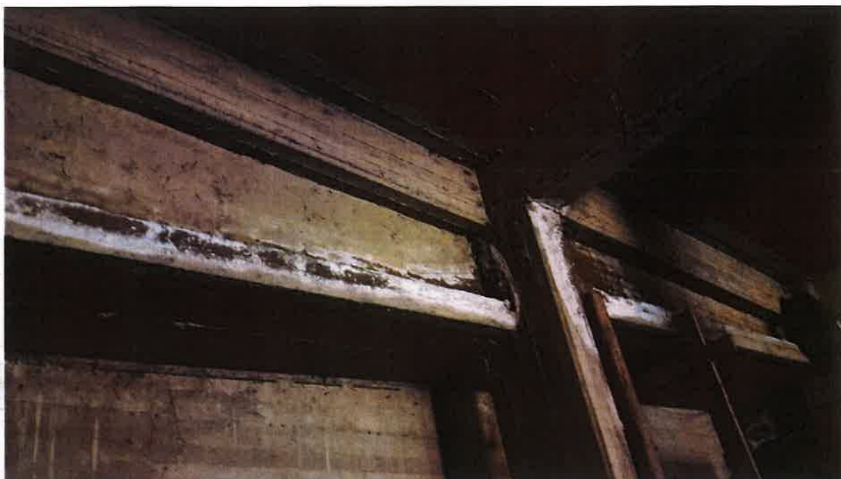
Foto 7 – Vista interna, particolare infiltrazioni lato terrapieno autorimessa (E)
