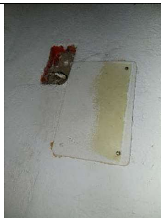
Particolare dell'impianto elettrico
