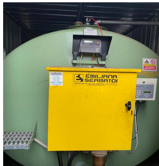
Cisterna gasolio Emiliana Serbatoi
