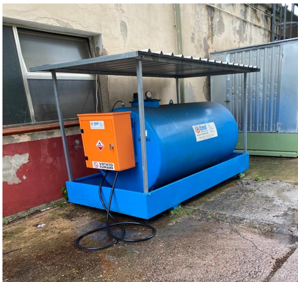
Cisterna gasolio TML
