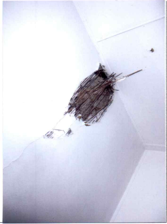
4 – Particolare d'interni: Distacco intonaco su soffitto Negozio
