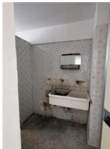
Foto Anti WC al piano primo
