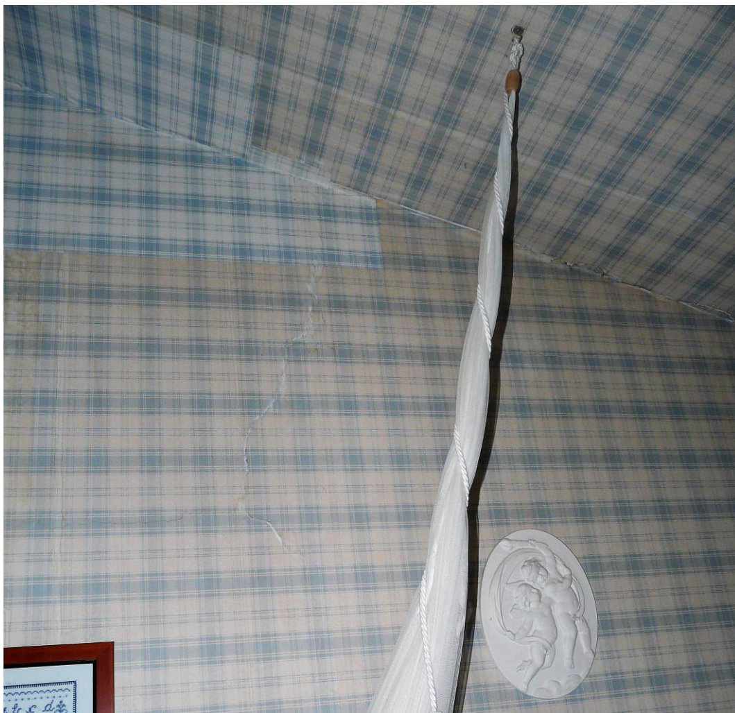
14- particolare lesioni interne
