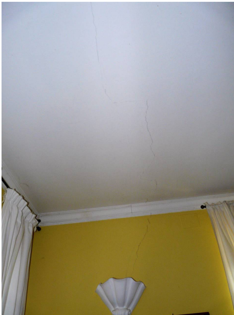
12-particolare lesioni interne
