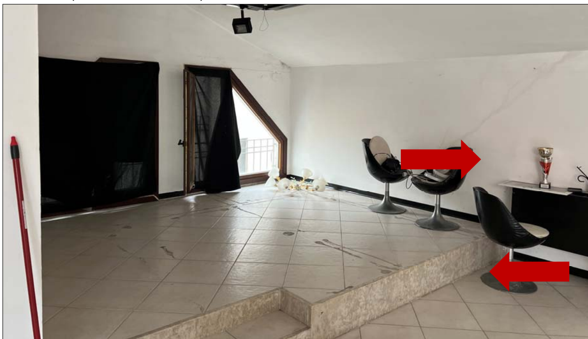
Difformità della loggia (gradino e pilastro)
