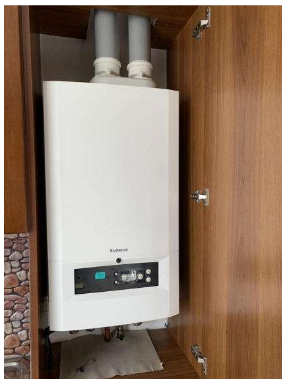
Caldaia impianto di riscaldamento acqua sanitaria
