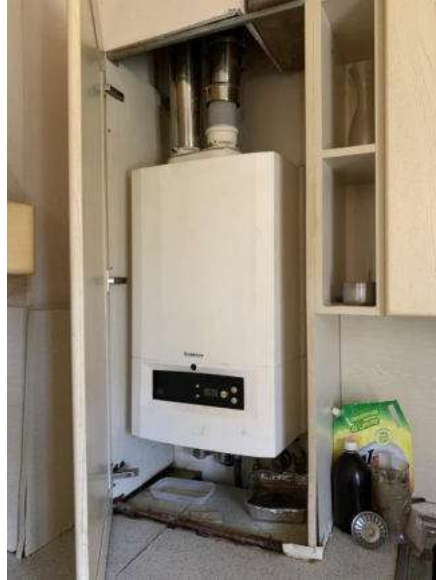
Caldaia impianto riscaldamento acqua sanitaria
