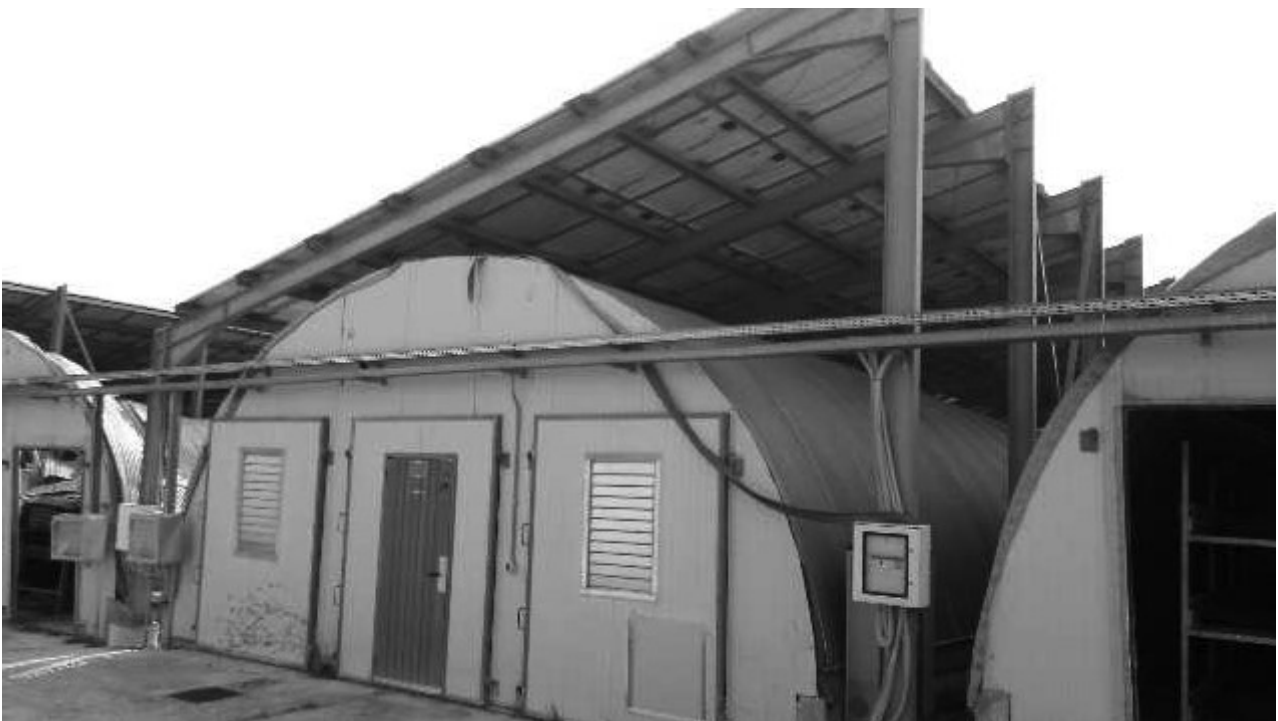
Postazione A: particolare serra con sovrastante impianto fotovoltaico
