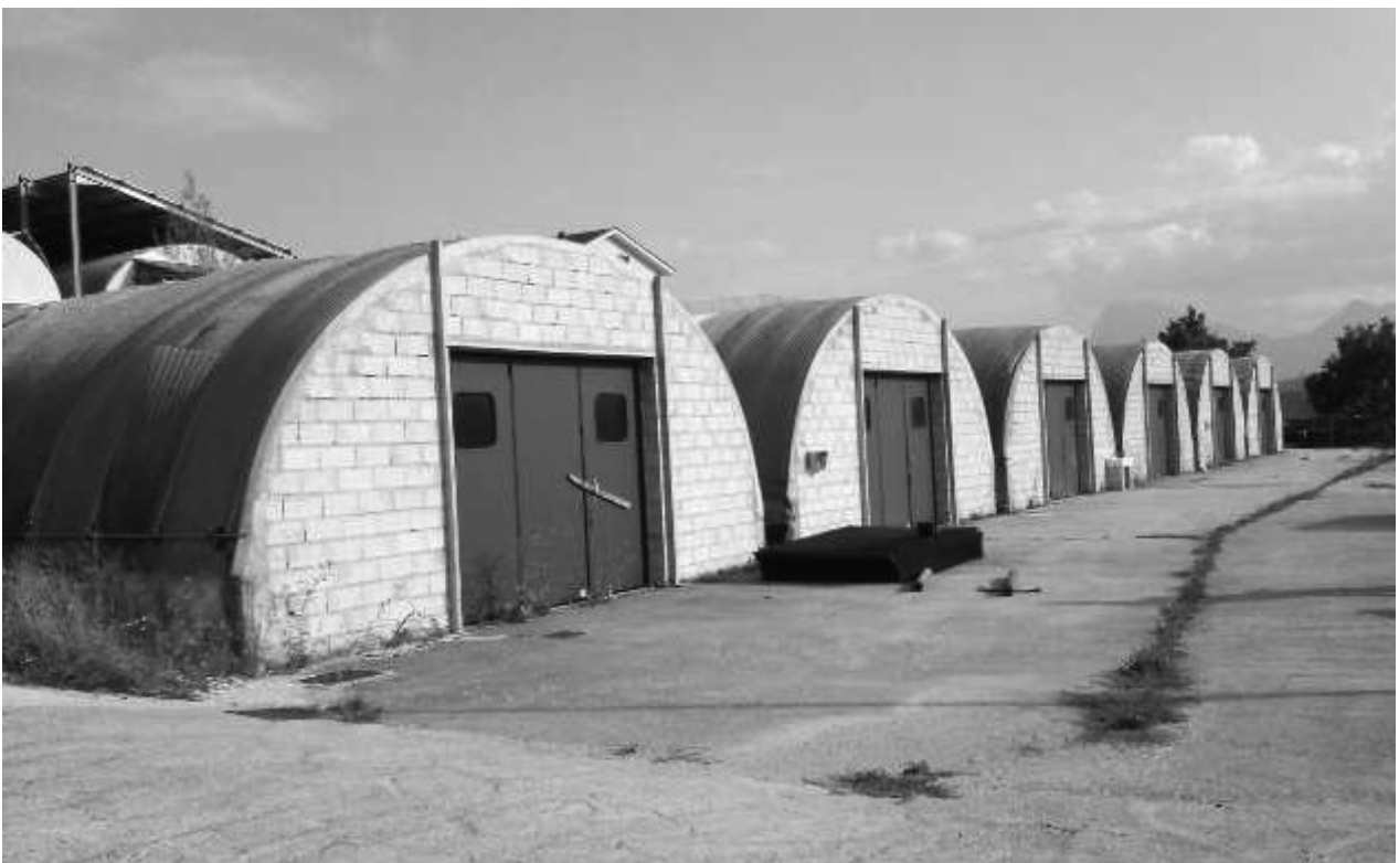
Postazione C : Serre ad uso magazzino ( danneggiate)
