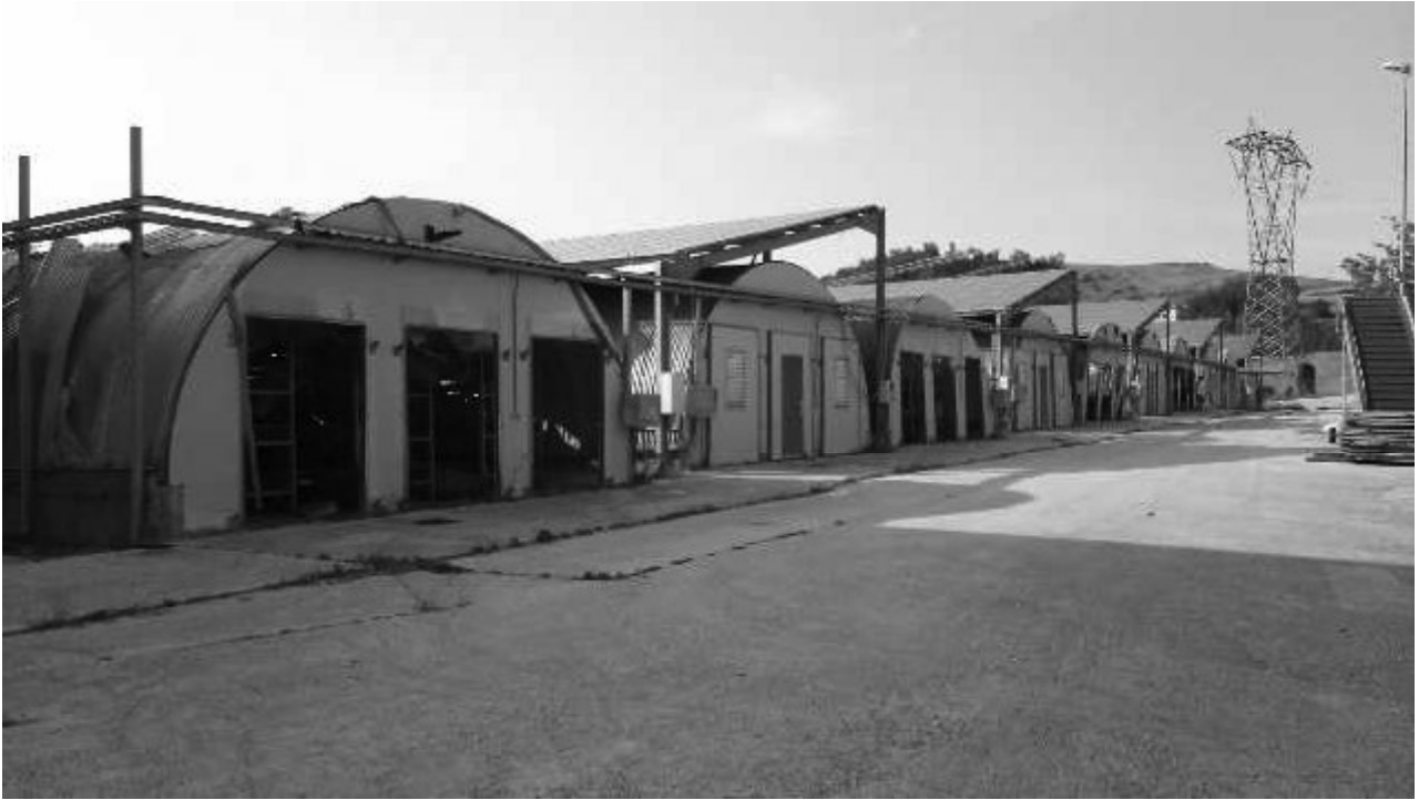
Postazione A: n.10 serre fungaia di cui n.4 hanno la copertura crollata
