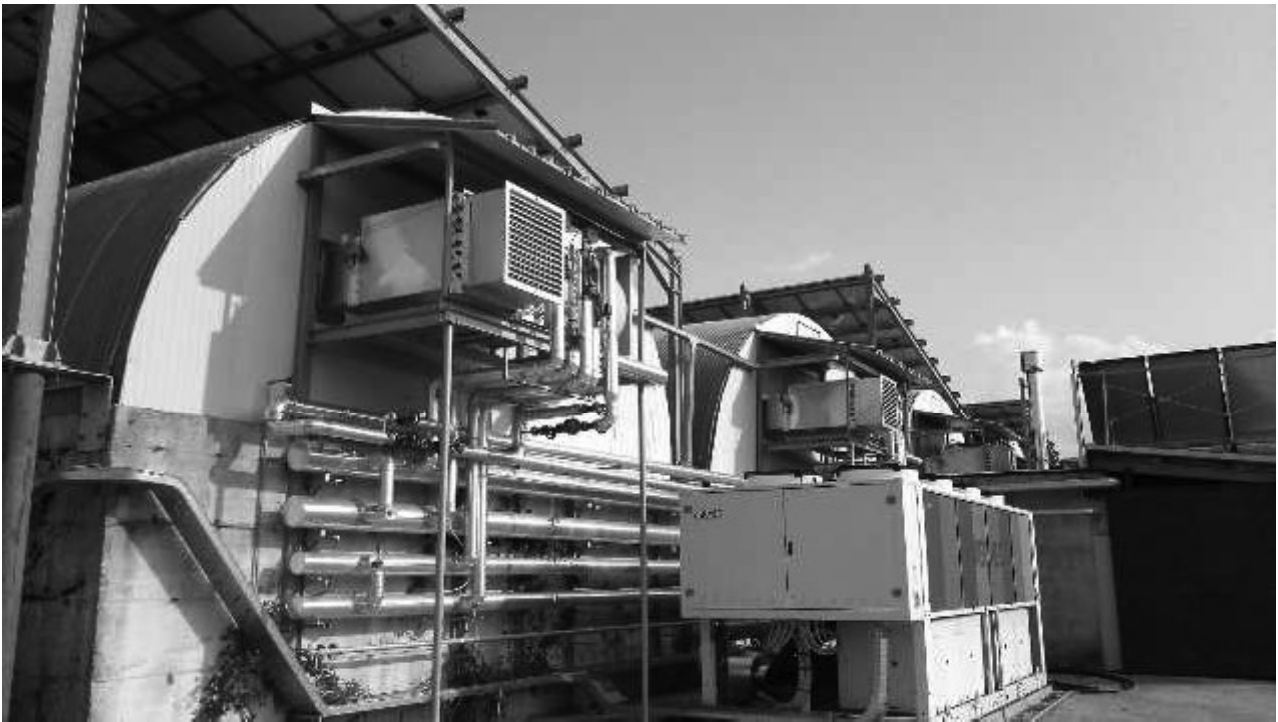
Impianto microclima per serre fungaia
