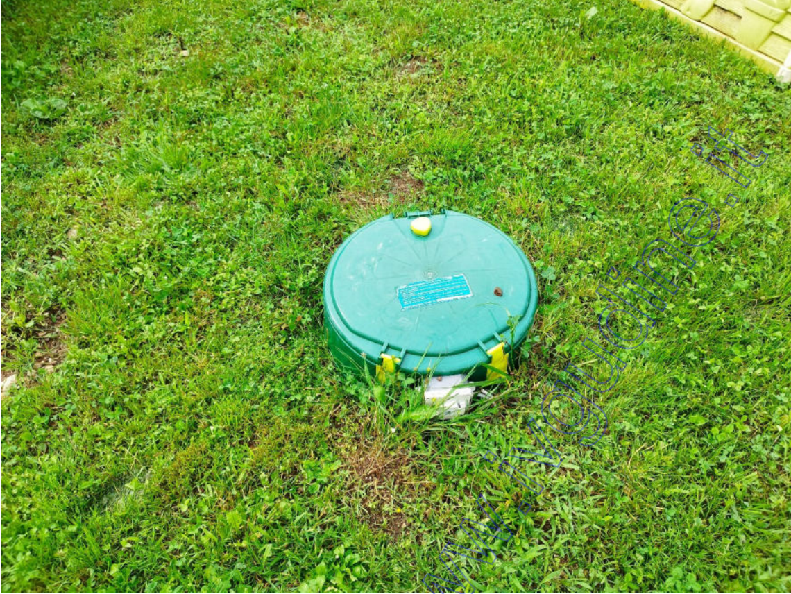
Particolare bombolone gpl interrato
